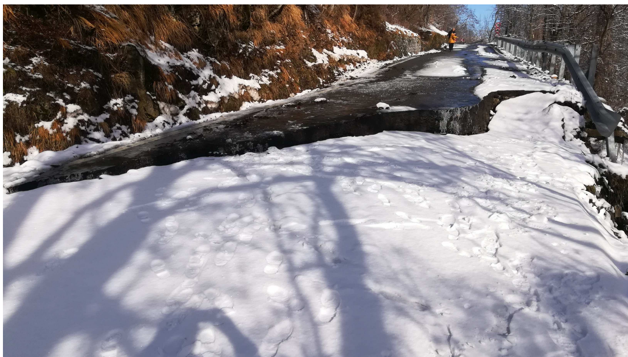
Foto 1 – Vista da sud del tratto interessato dal cedimento della sede stradale (05/02/2019).
