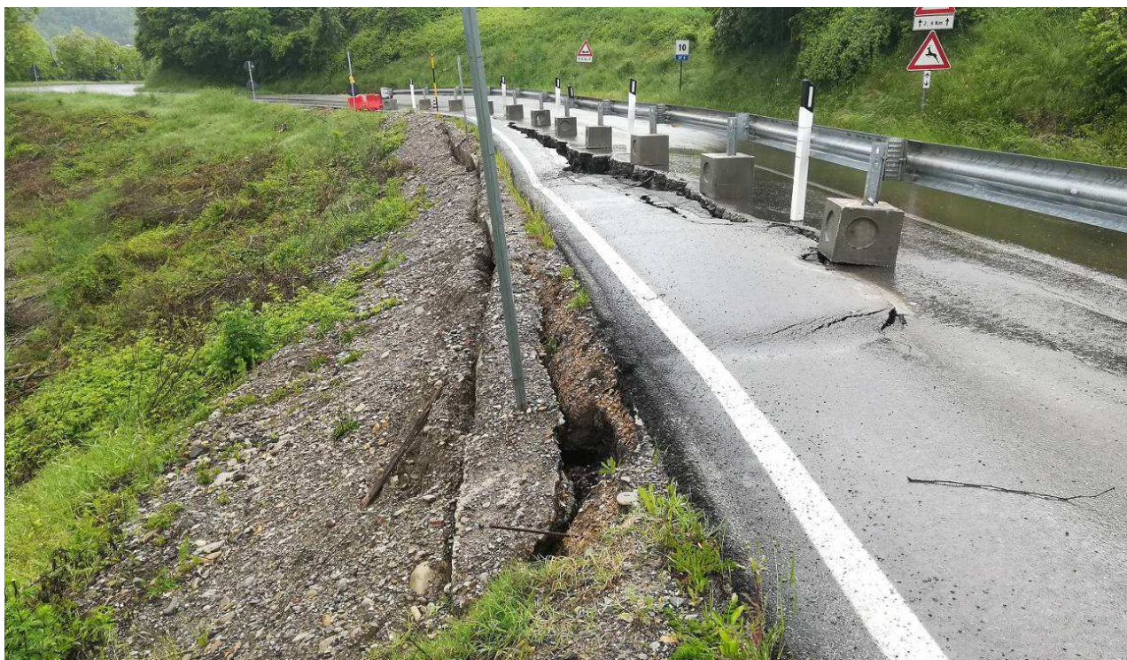
Foto 3 – Particolare della scarpata e del piano viabile della strada provinciale.
