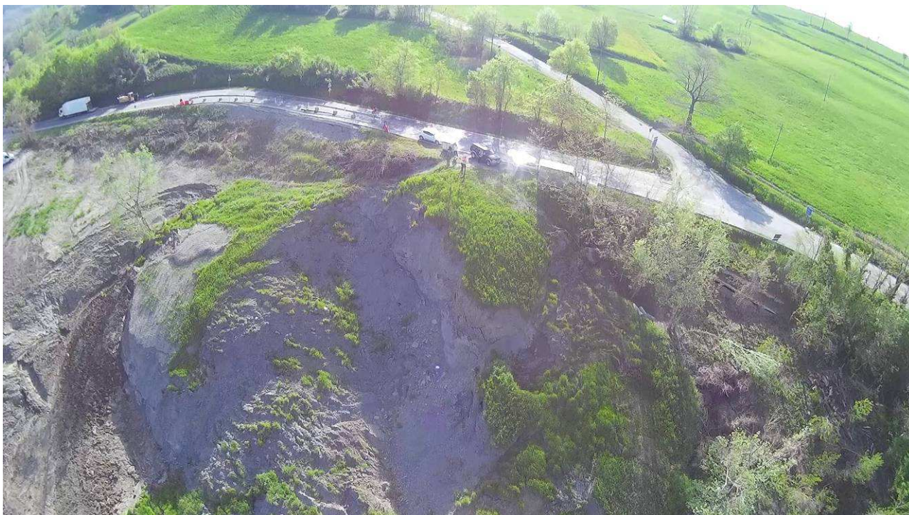
Foto 1 – Vista dall'alto della testata e del coronamento del movimento franoso che interessa la SP 9 al km 10+000.
