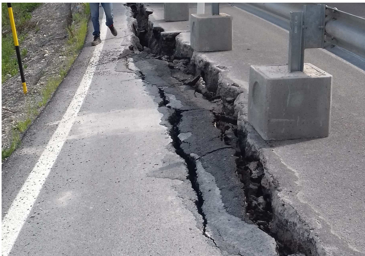
Foto 4 – Particolare dell'evoluzione del cedimento del piano viabile della strada provinciale.
