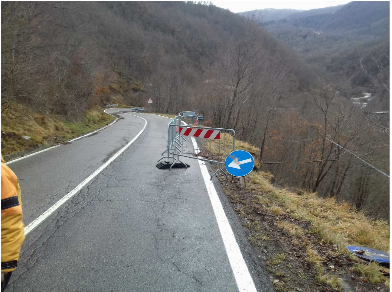
Foto 2 – Particolare della scarpata di valle interessata dal dissesto.
