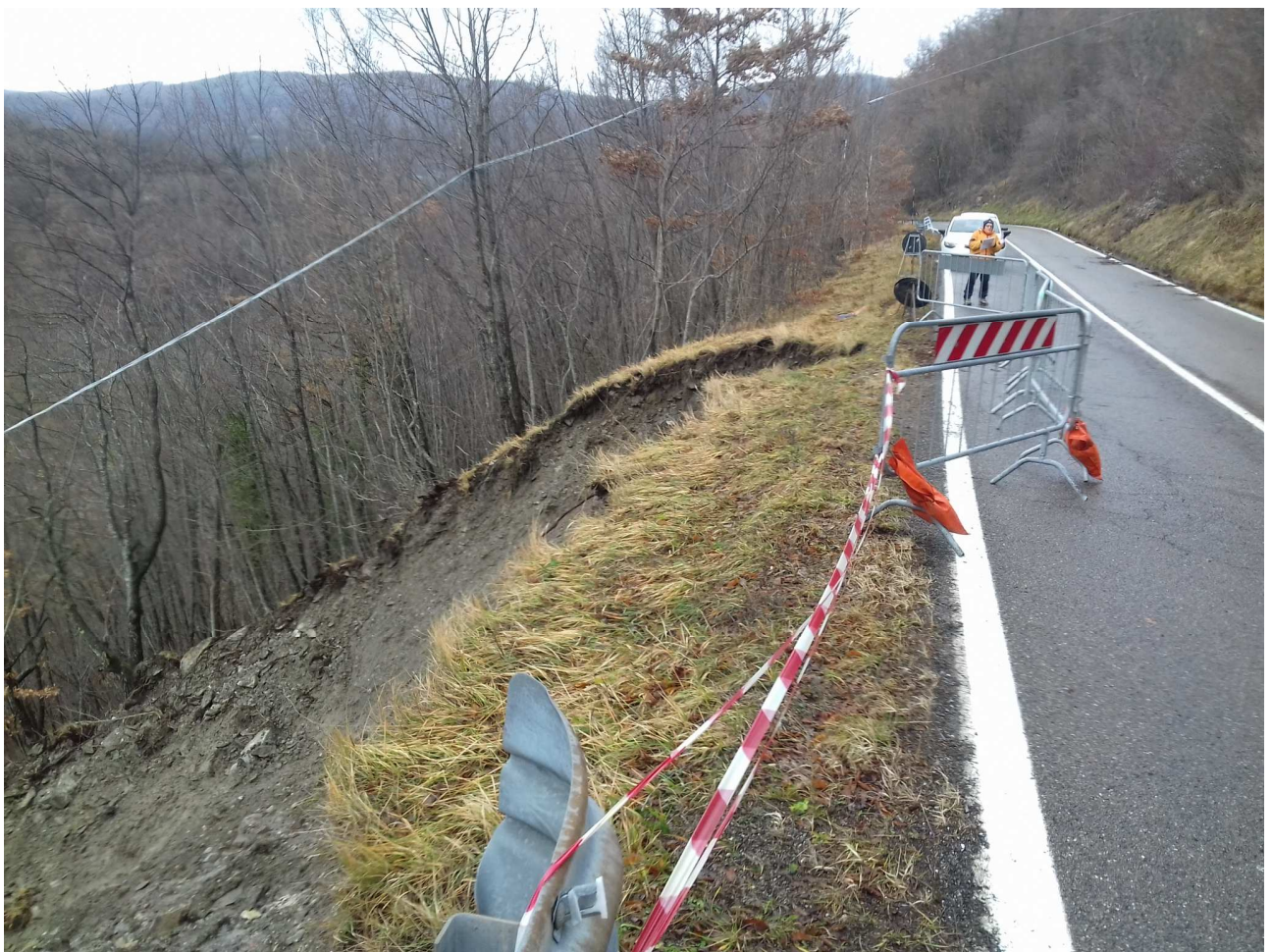
Foto 1 – Particolare della scarpata di valle interessata dal dissesto.
