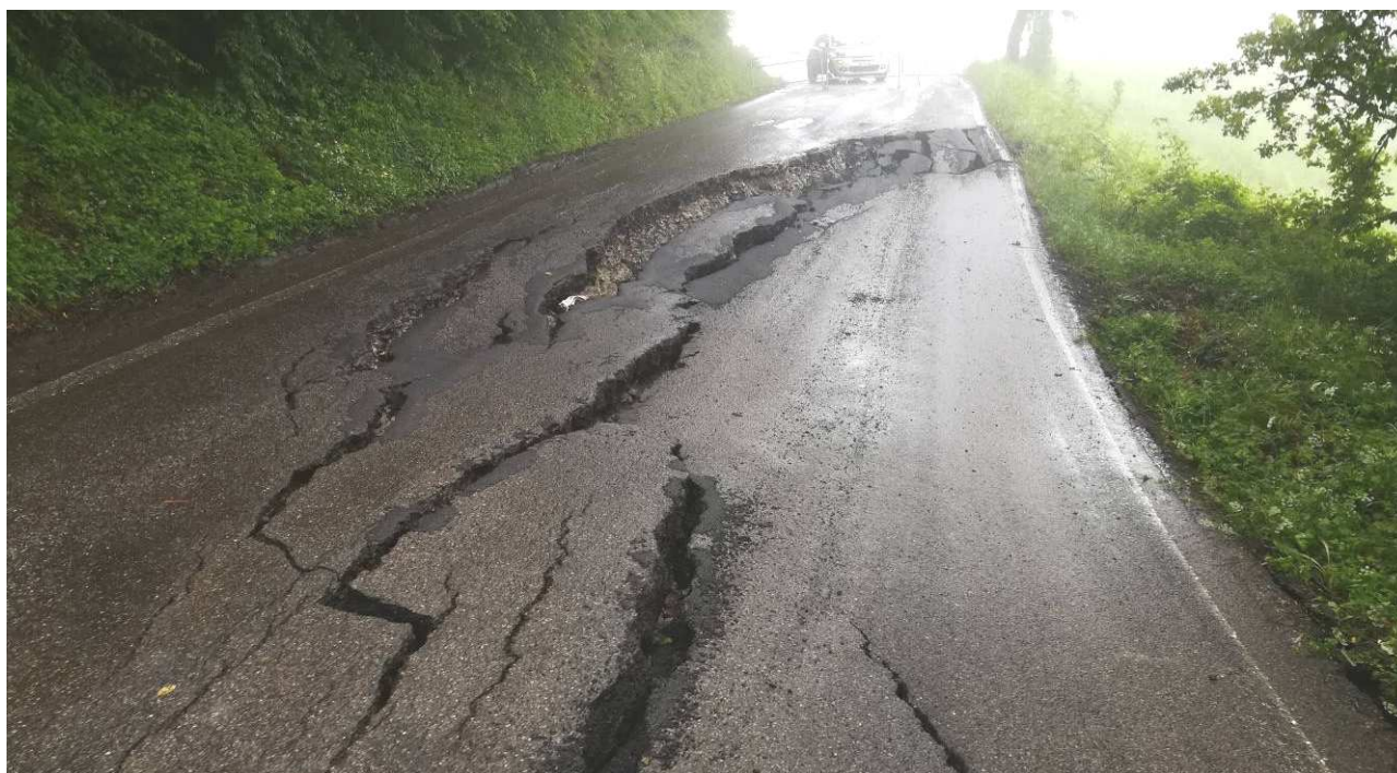
Foto 2 - Vista da nord del tratto interessato dal cedimento della sede stradale (29/05/2019).
