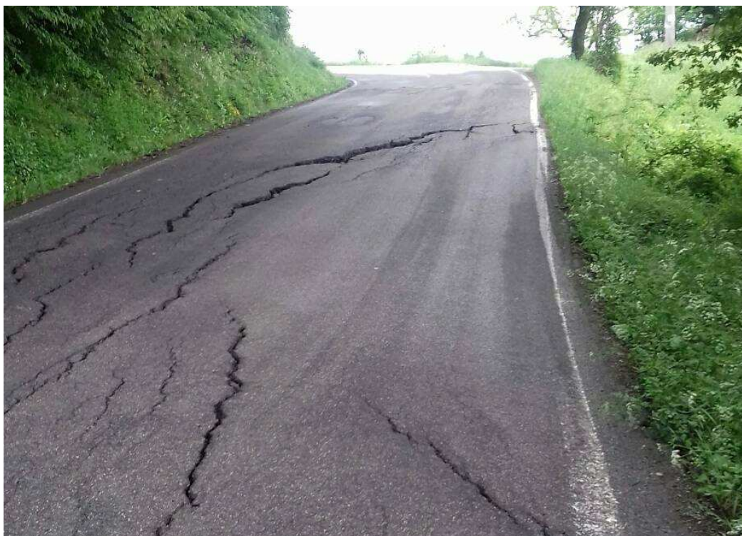
Foto 1 - Vista da nord della sede stradale interessata dalle prime fessure di trazione (28/05/2019).
