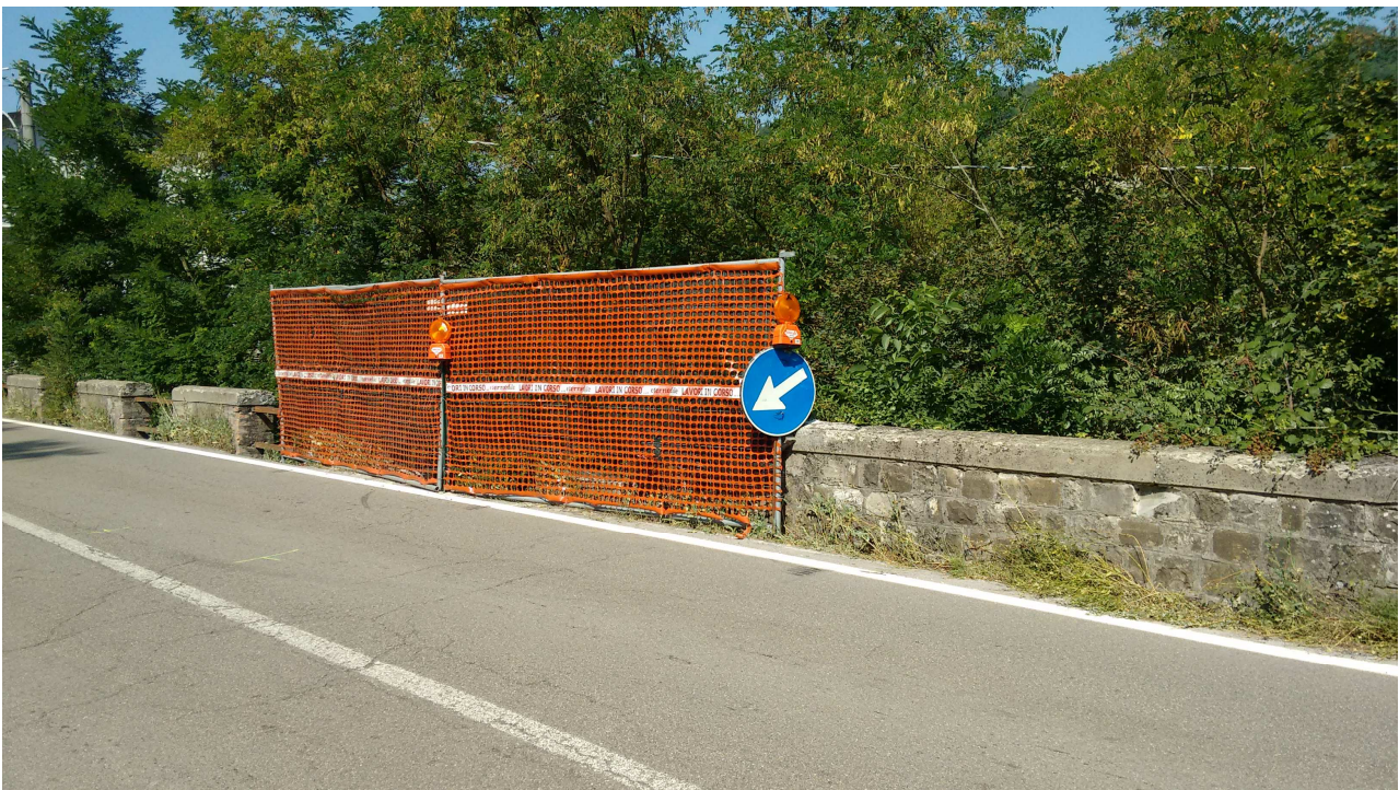
PONTE SUL RIO CURRADA AL KM 32+450 DELLA SP513R SITUAZIONE ATTUALE DOPO L'INCIDENTE SUL LATO DI VALLE:
