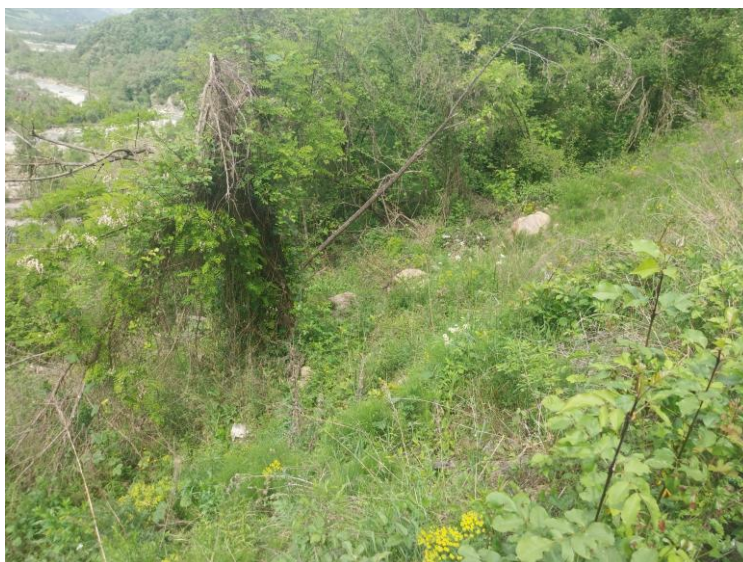
Presenta di alberature secche e trovanti instabili
