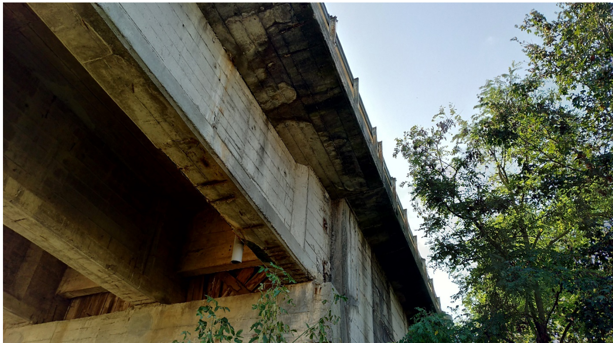
Figura 4 – dilavamento, distacco del copriferro
