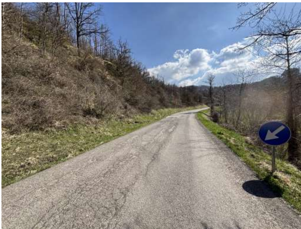
Foto 2 – Porzione dissestata a monte dell’abitato di Montemiscoso
