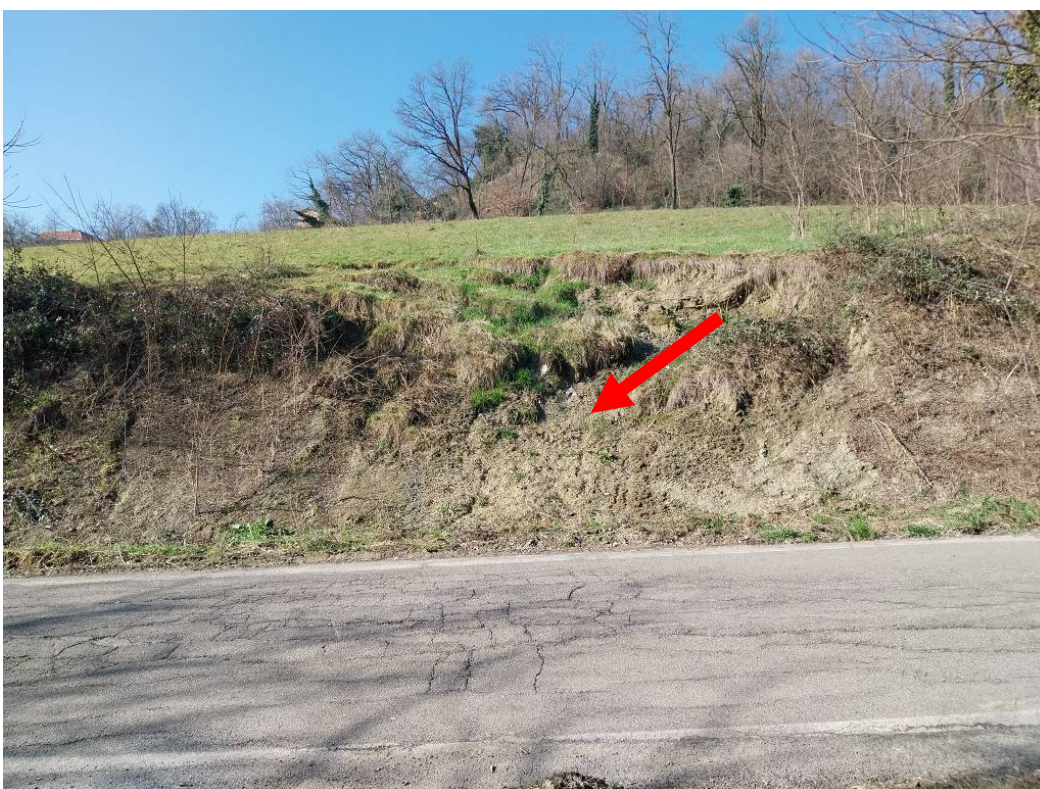
Foto 3 – Vista frontale del franamento della scarpata di monte al 06/02/2025, si notano ancora venute d'acqua presenti lungo la scarpata.
