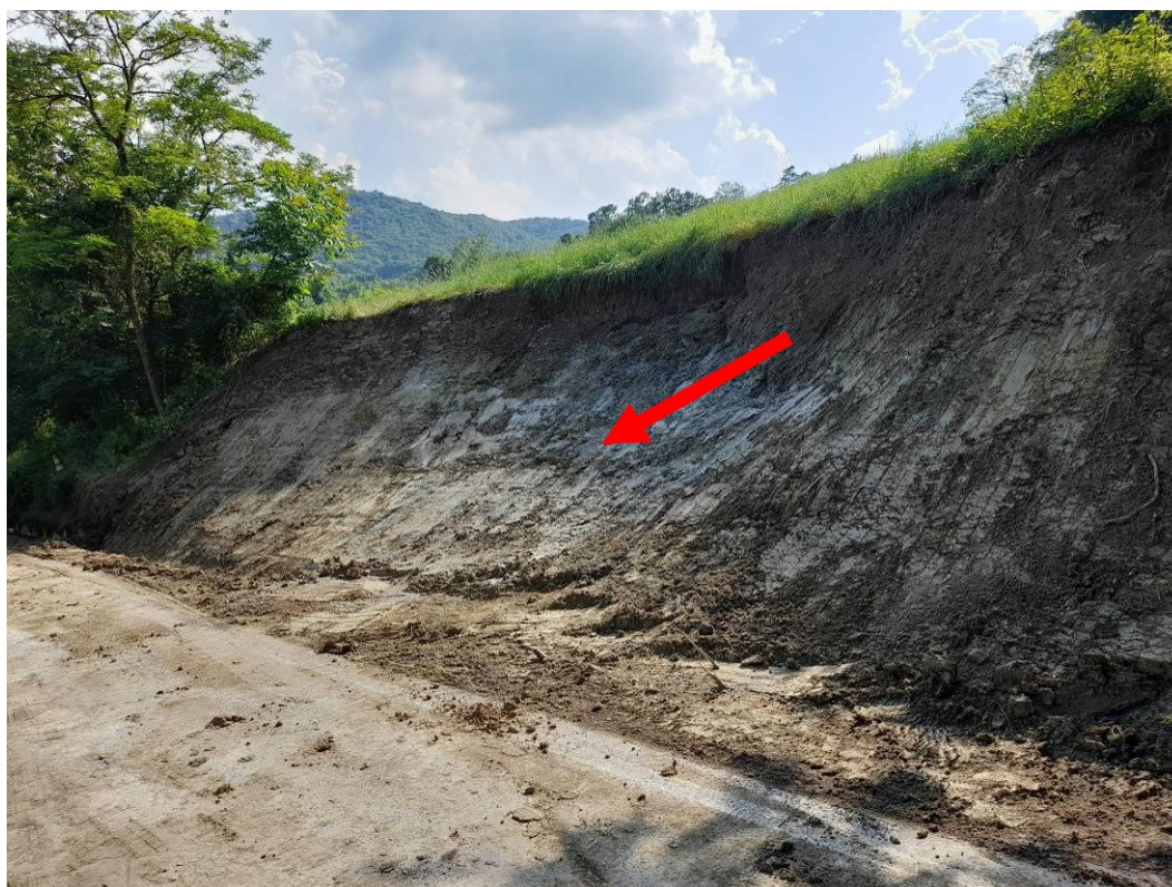
Foto 1 – Vista della scarpata il giorno seguente la data dell'evento (22/05/2023) dopo i primi interventi per liberare la sede stradale dal terreno franato, si notano le venute d'acqua presenti lungo la scarpata che ne hanno causato il franamento.
