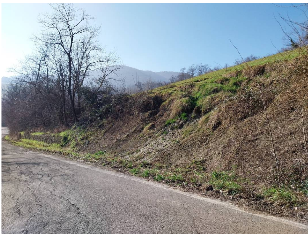
Foto 2 – Vista della porzione di scarpata di monte interessata dal dissesto al 06/02/2025.
