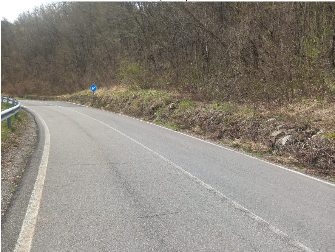
Foto 1 – vista della SP 9 nel tratto interessato dal dissesto (da valle)
