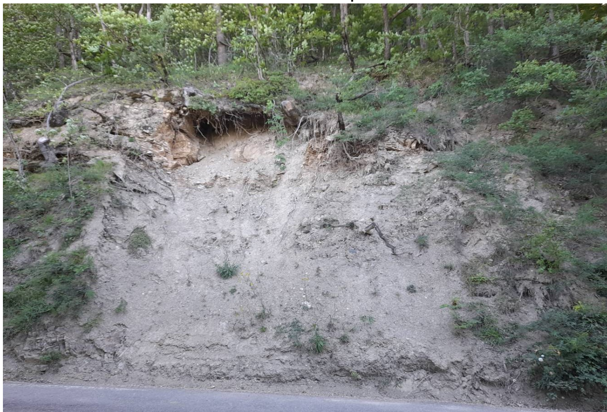
Foto 3 – Vista della scarpata di monte della SP 79 al km 16+800
