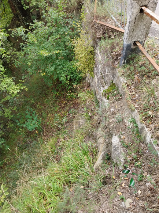
Foto 3 – vista del muro sottoscarpa con crolli
