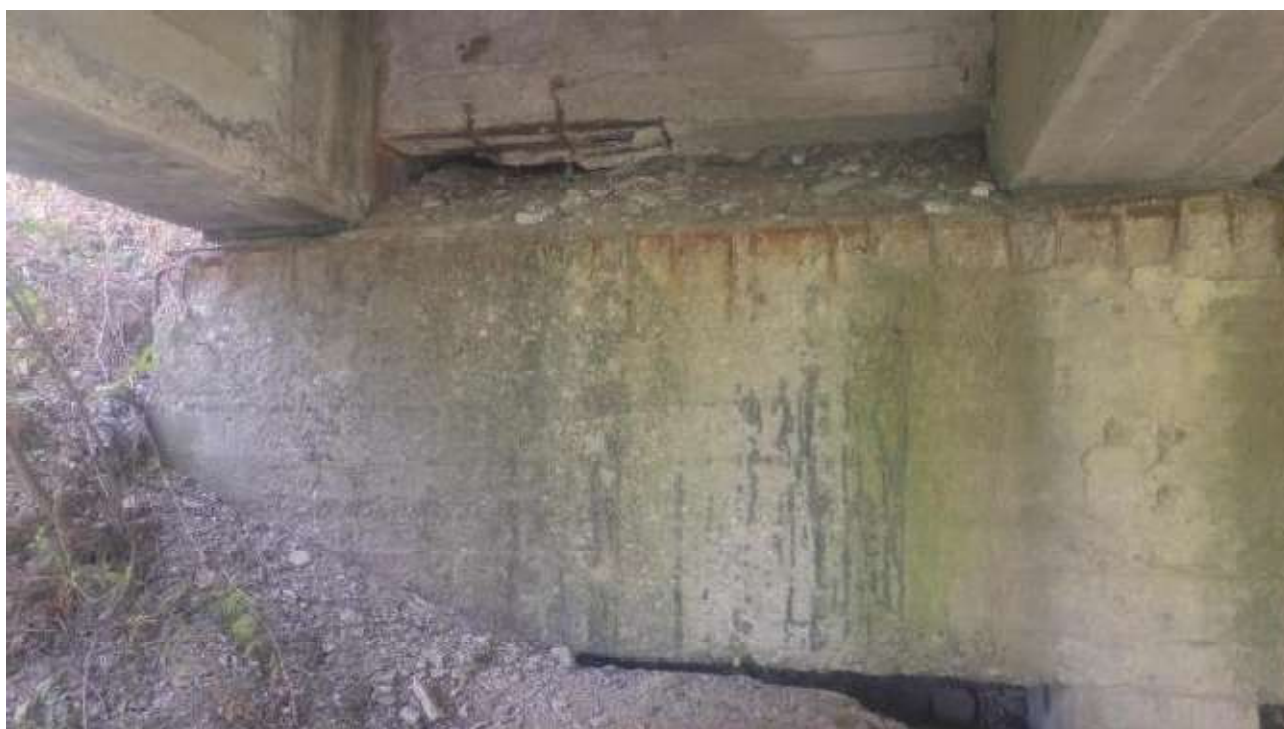
Figura 11 - Vista degrado spalle est e traverso terminale
