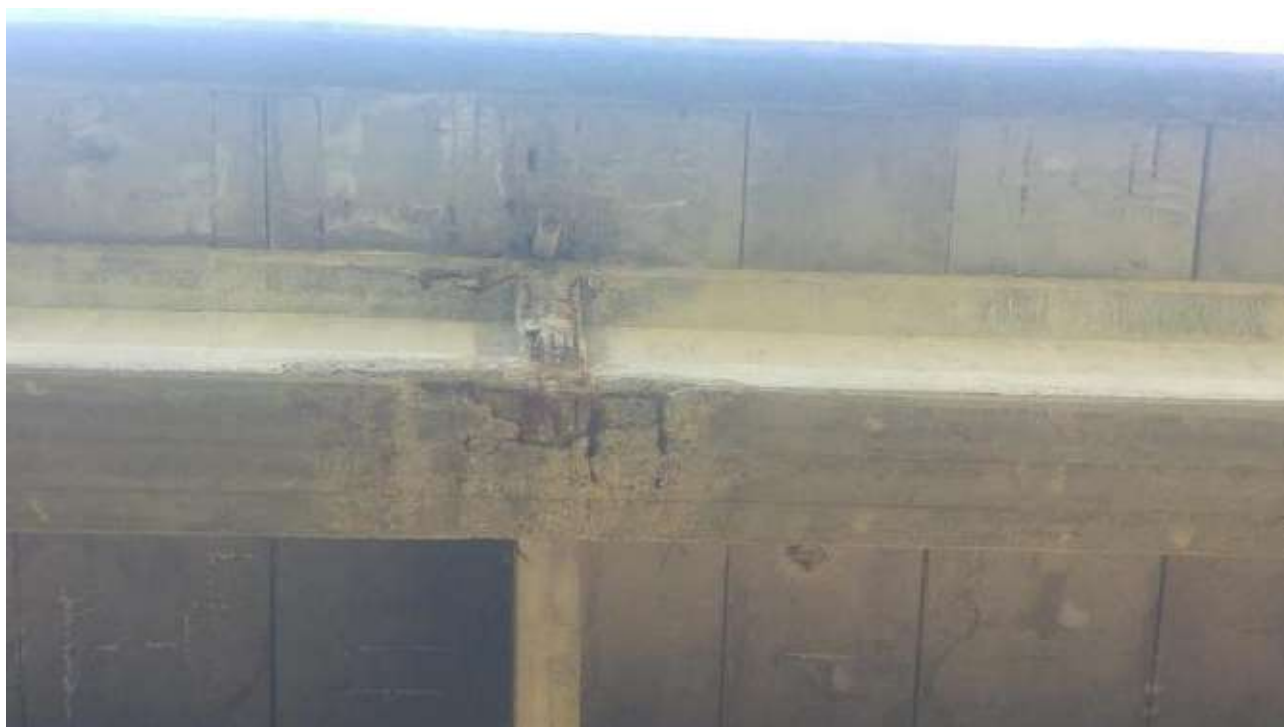
Figura 10 - Vista degrado di testata di traverso intermedio
