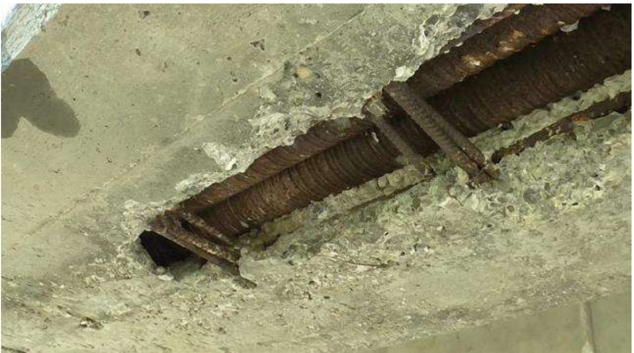
Figure 13 - Guaine ossidate dei cavi di precompressione
