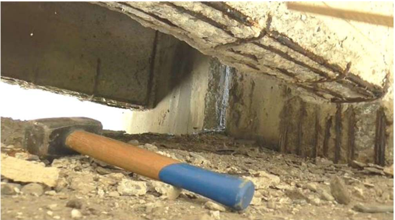
Figure 12 - Vista degrado trasverso
