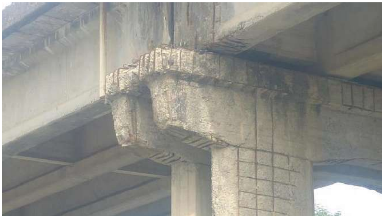
Figura 8 - Vista degrado trave pulvino
