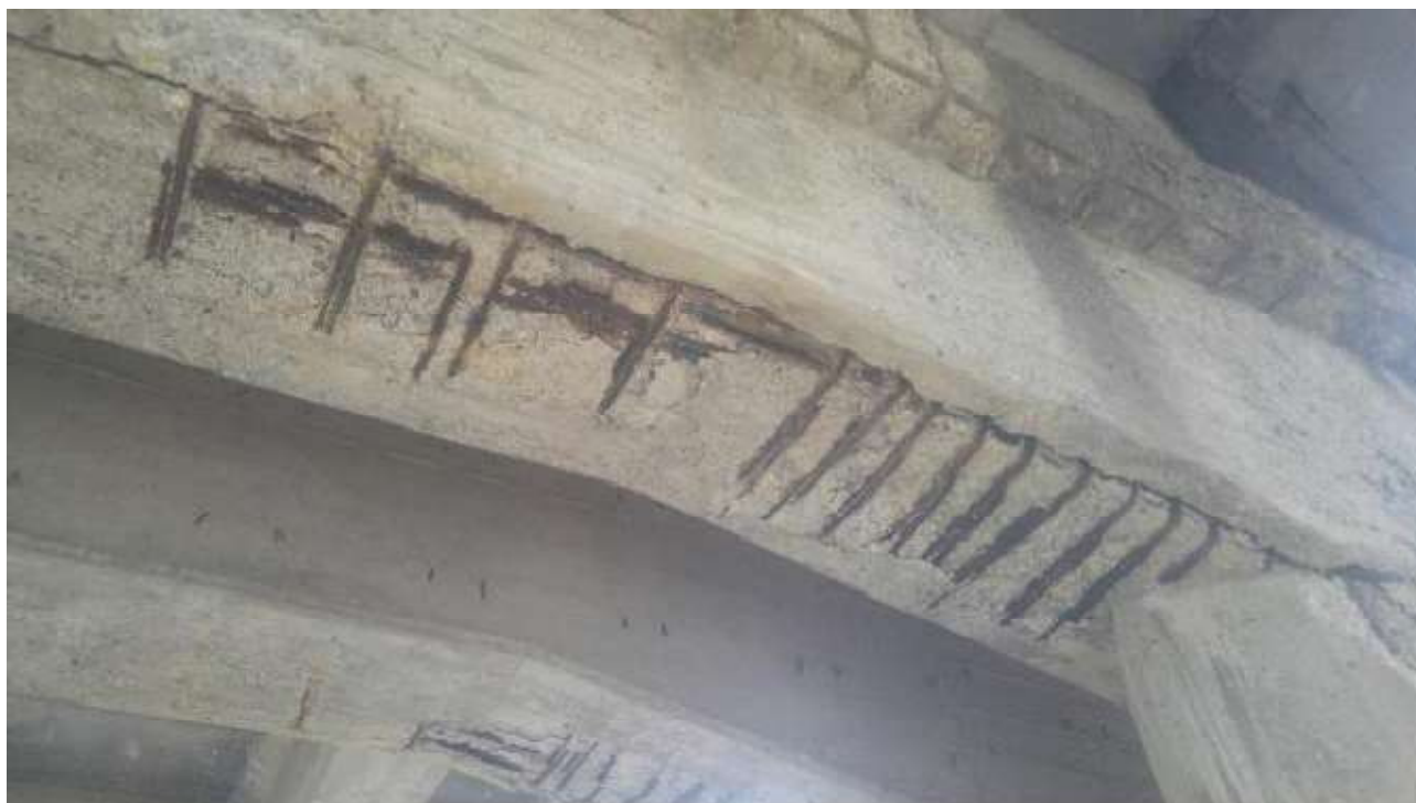
Figura 9 - Vista degrado intradosso trave pulvino
