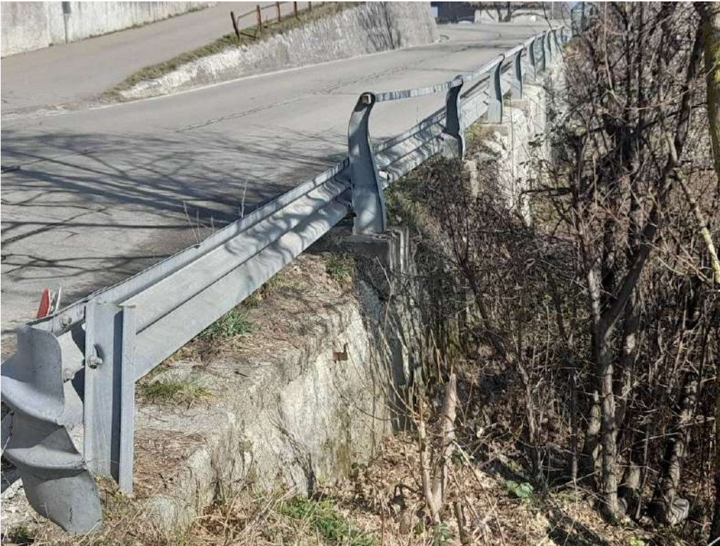
Foto 9 - vista della barriera stradale su muro A, del degrado del muro e del cordolo sommitale
