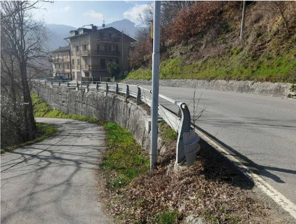
Foto 7 - vista della barriera stradale su muro B, del degrado del muro e del cordolo sommitale, dei pali di pubblica illuminazione
