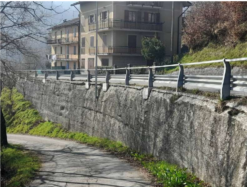
Foto 8 - vista dell'erosione superficiale del muro B e del cordolo sommitale, dei pali di pubblica illuminazione
