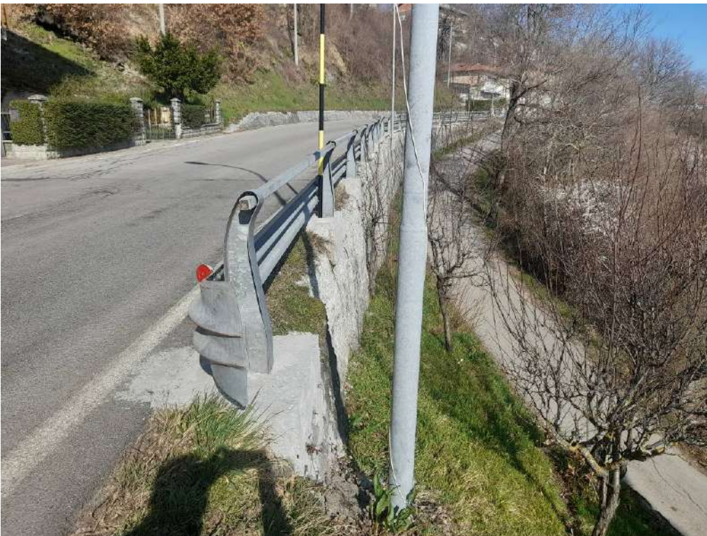
Foto 6 - vista della barriera stradale su muro B, del degrado del muro e del cordolo sommitale, dei pali di pubblica illuminazione
