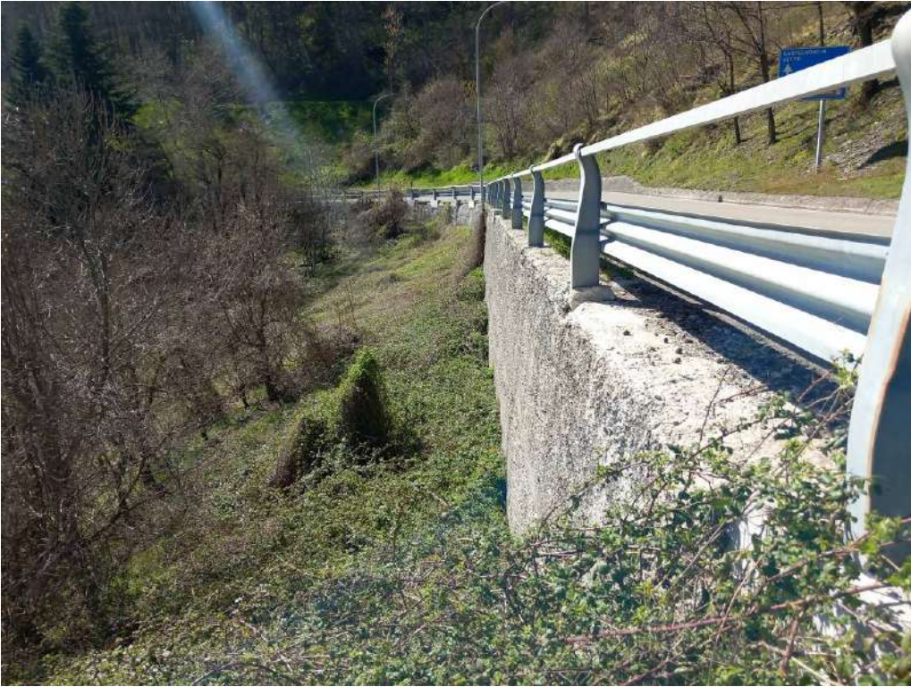
Foto 3 - vista della barriera stradale su muro C, del degrado del muro e del cordolo sommitale, dei pali di pubblica illuminazione
