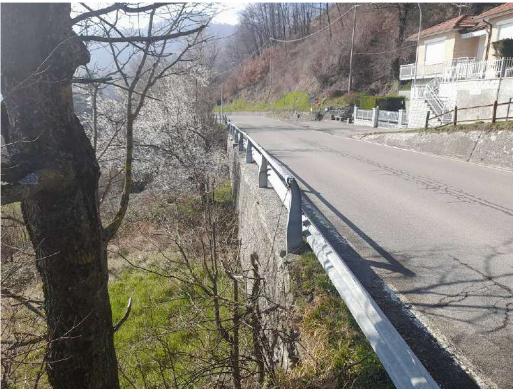
Foto 10 - vista della barriera stradale su muro A, del degrado del cordolo e della pavimentazione stradale
