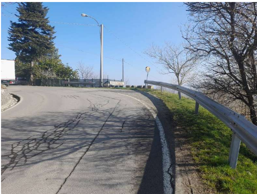
Foto 2 - vista del tratto stradale oggetto di intervento, dei degradi della pavimentazione stradale e dei sistemi di ritenuta discontinui esistenti
