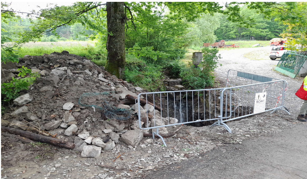
Foto 2 – Vista del punto in cui si è verificata l’ostruzione dell’attraversamento stradale con a lato il materiale proveniente dal fosso di scolo acque pubbliche
