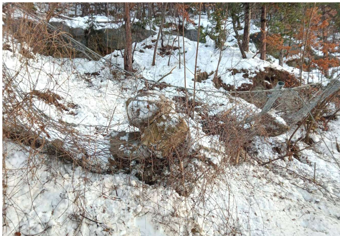
Foto 2 – Particolare del materiale trattenuto dalla barriera paramassi e del montante della barriera deformato
