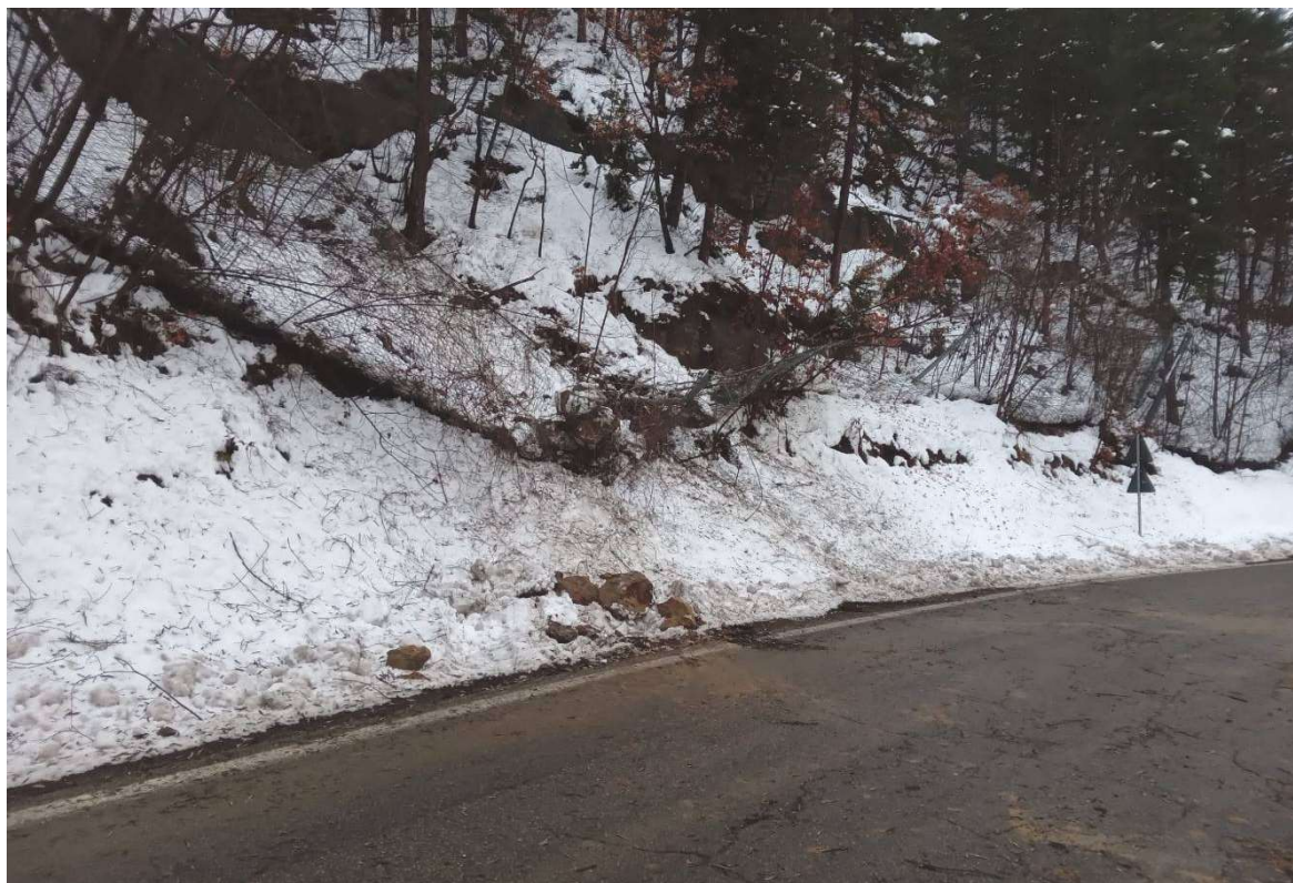
Foto 1 – Vista della barriera paramassi divelta dal materiale costituito da massi, detriti e neve sceso dal versante a monte della strada provinciale
