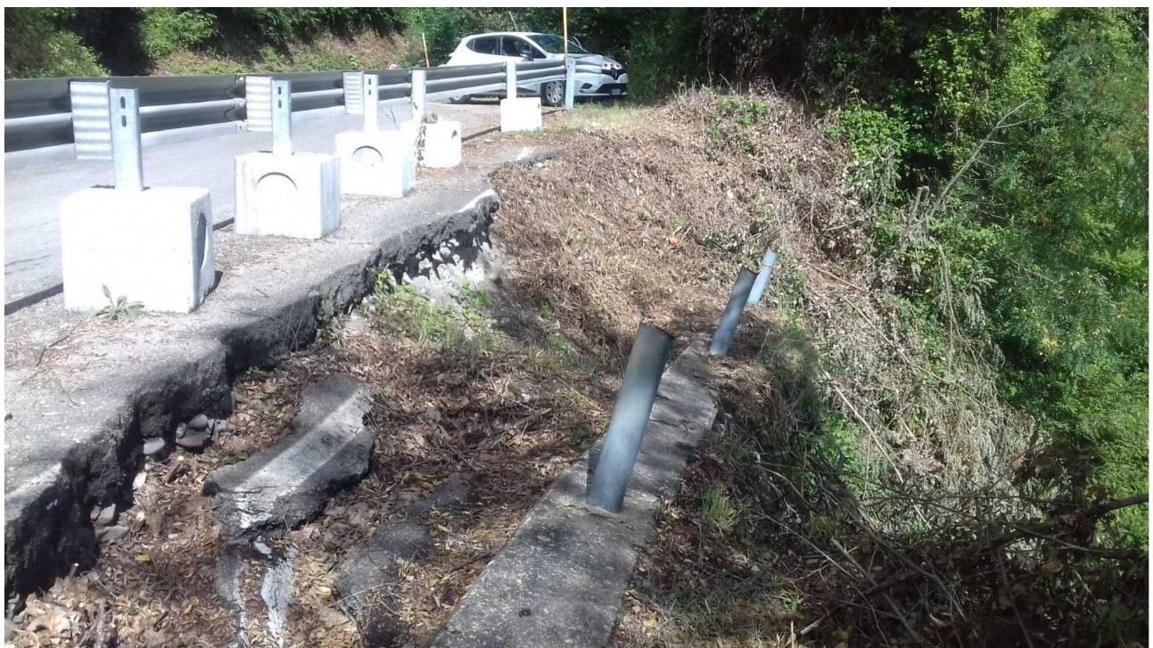
Foto 4 – Particolare del cedimento dei manufatti esistenti, nella porzione del dissesto di monte.
