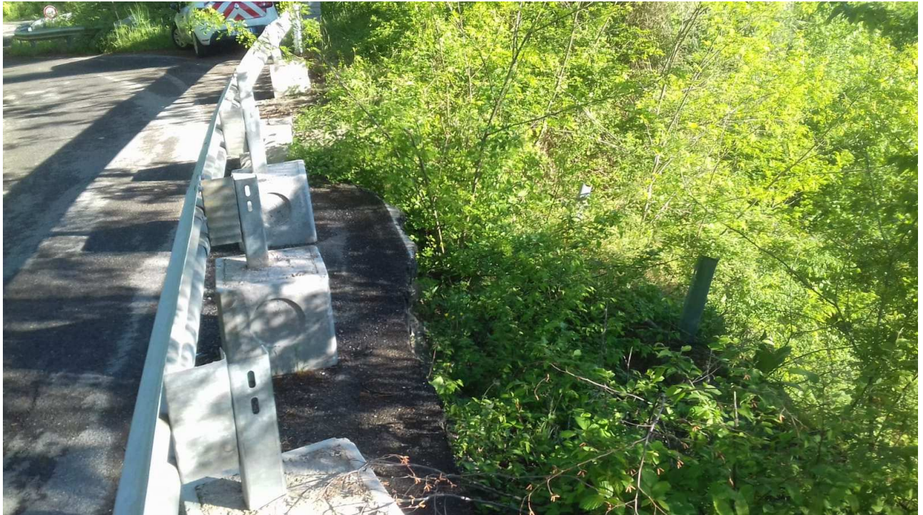
Foto 3 – Vista della scarpata in dissesto, con interessamento parziale della carreggiata stradale, della porzione del dissesto di monte.
