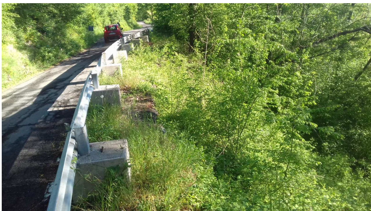
Foto 2 – Vista della scarpata in dissesto, con interessamento parziale della carreggiata stradale, della porzione del dissesto di valle.
