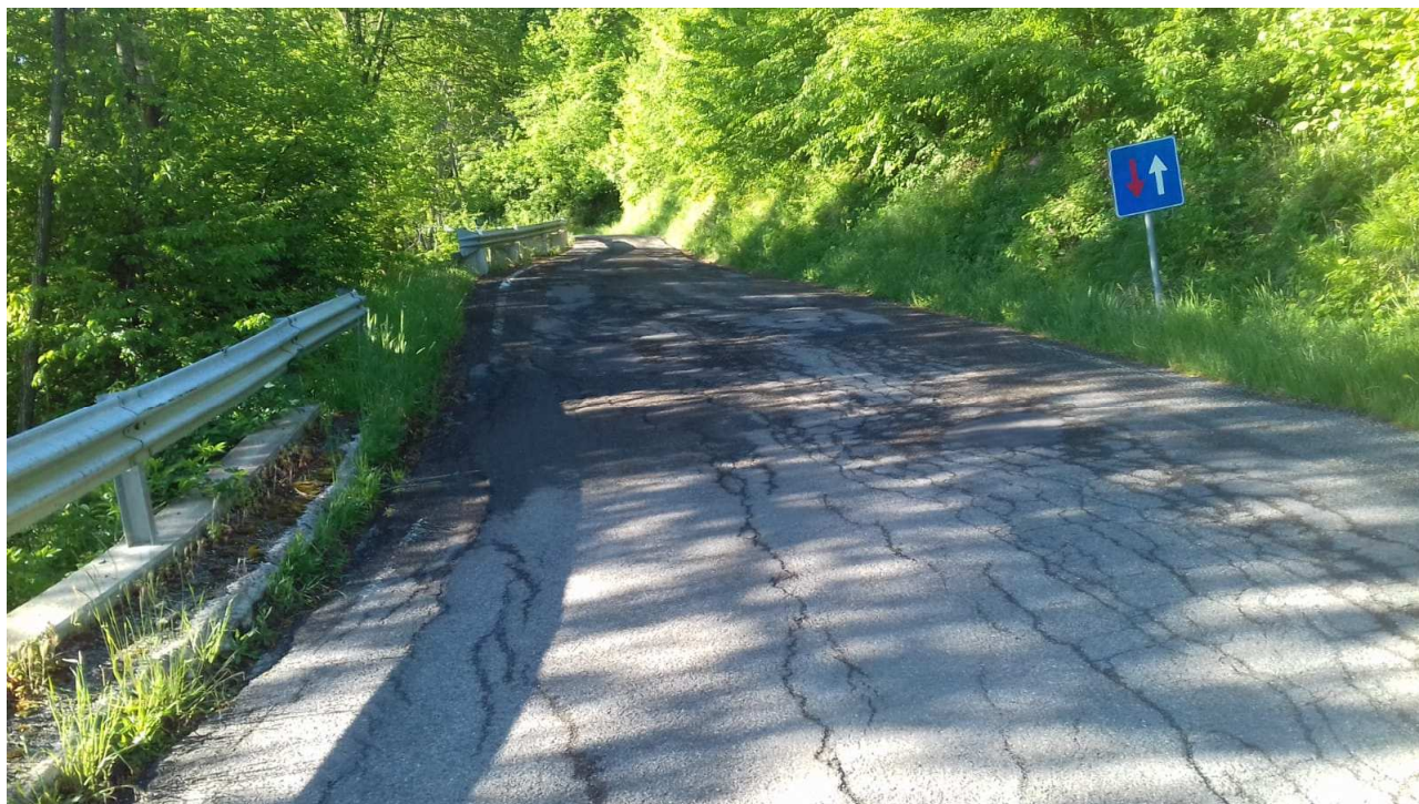
Foto 1 – Vista da valle del tratto di strada interessata dal dissesto con la segnaletica di senso unico alternato.
