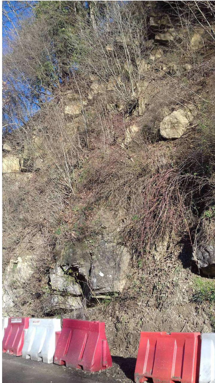
Foto 2 – Vista della scarpata dopo l’evento del dicembre 2017.
