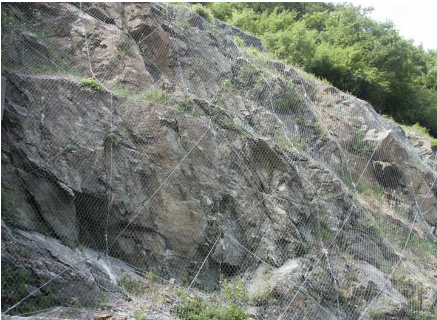
Fig. 2 - Esempio di posa della rete paramassi con disposizione degli ancoraggi per il passaggio delle funi.
