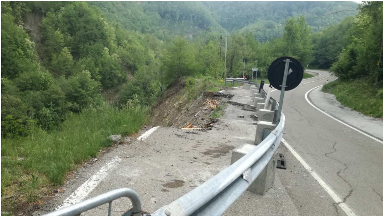
Foto 2- Particolare della scarpata di valle interessata dal dissesto.
