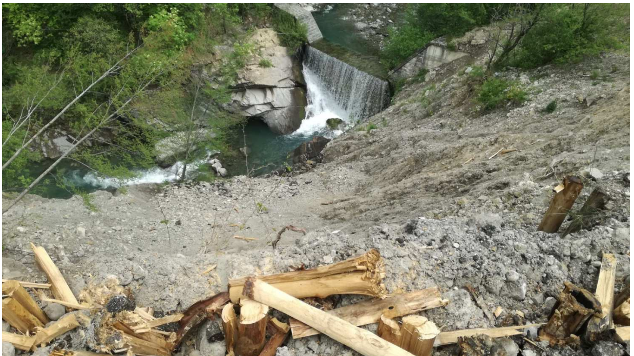
Foto 3- Particolare della scarpata di valle interessata dal dissesto.
