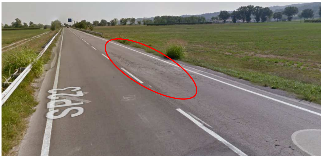
Foto 2 - Vista dei cedimenti della pavimentazione con la formazione di ormaie e depressioni nel tratto oggetto di intervento dalla SP 23.
