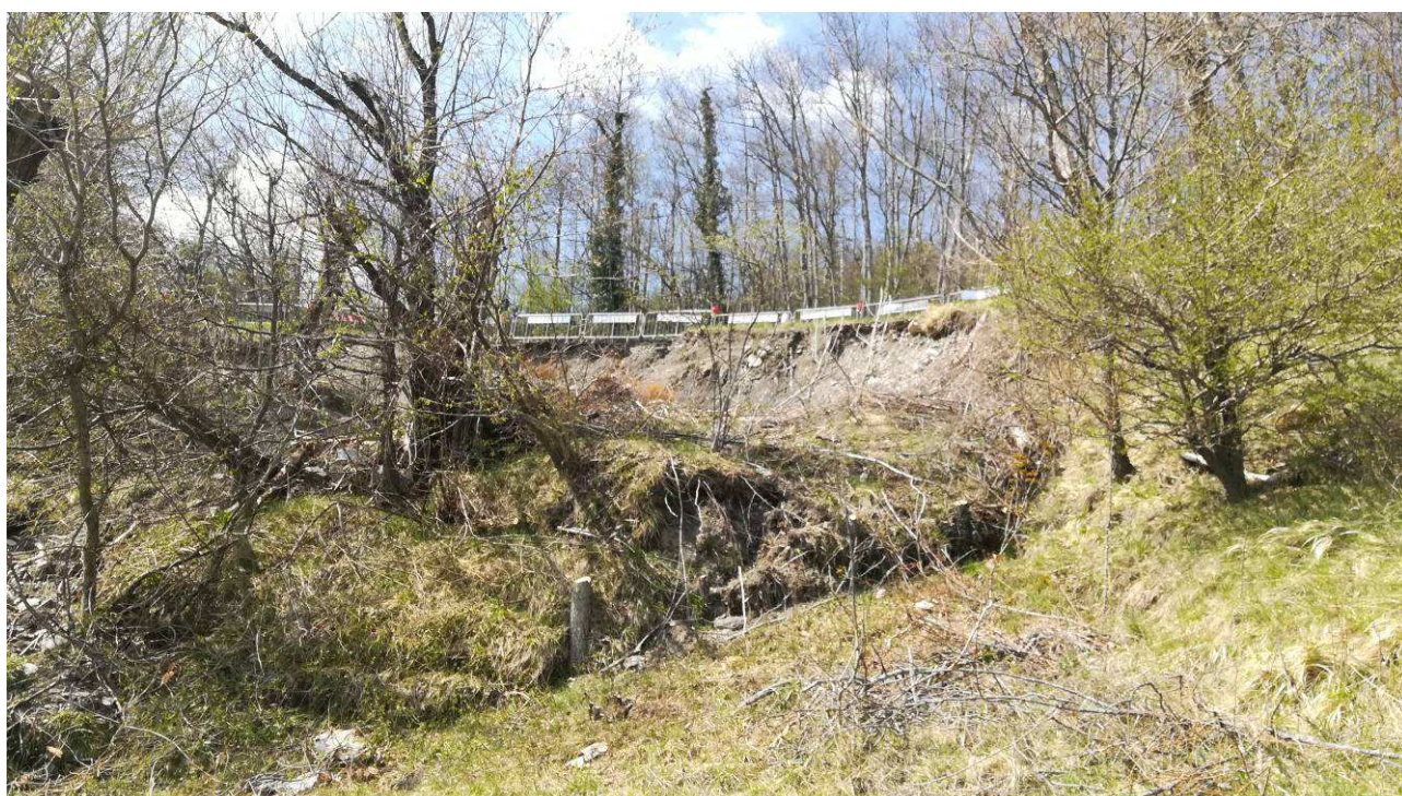
Foto 4 – Vista da valle del colamento del terreno franato lungo il pendio (18/04/2019).
