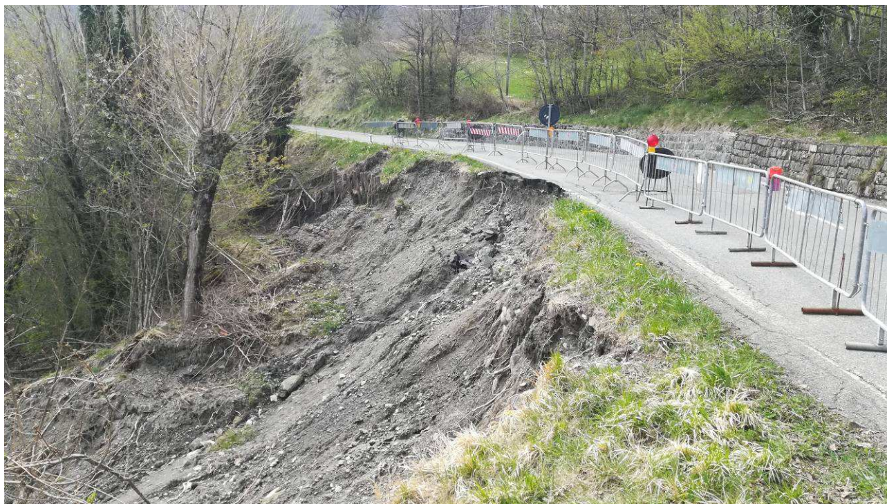
Foto 3 – Vista da est del dissesto che ha interessato la scarpata di valle (18/04/2019).
