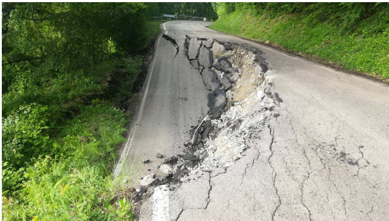
Foto 3 – Vista da sud del tratto interessato dal cedimento della sede stradale (30/05/2019).
