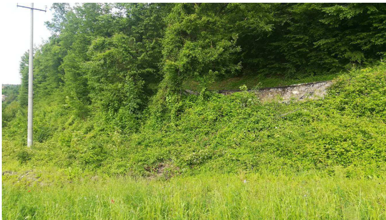
Foto 5 – Vista del dissesto dalla base della scarpata di valle, in corrispondenza dell'unghia della frana (30/05/2019).
