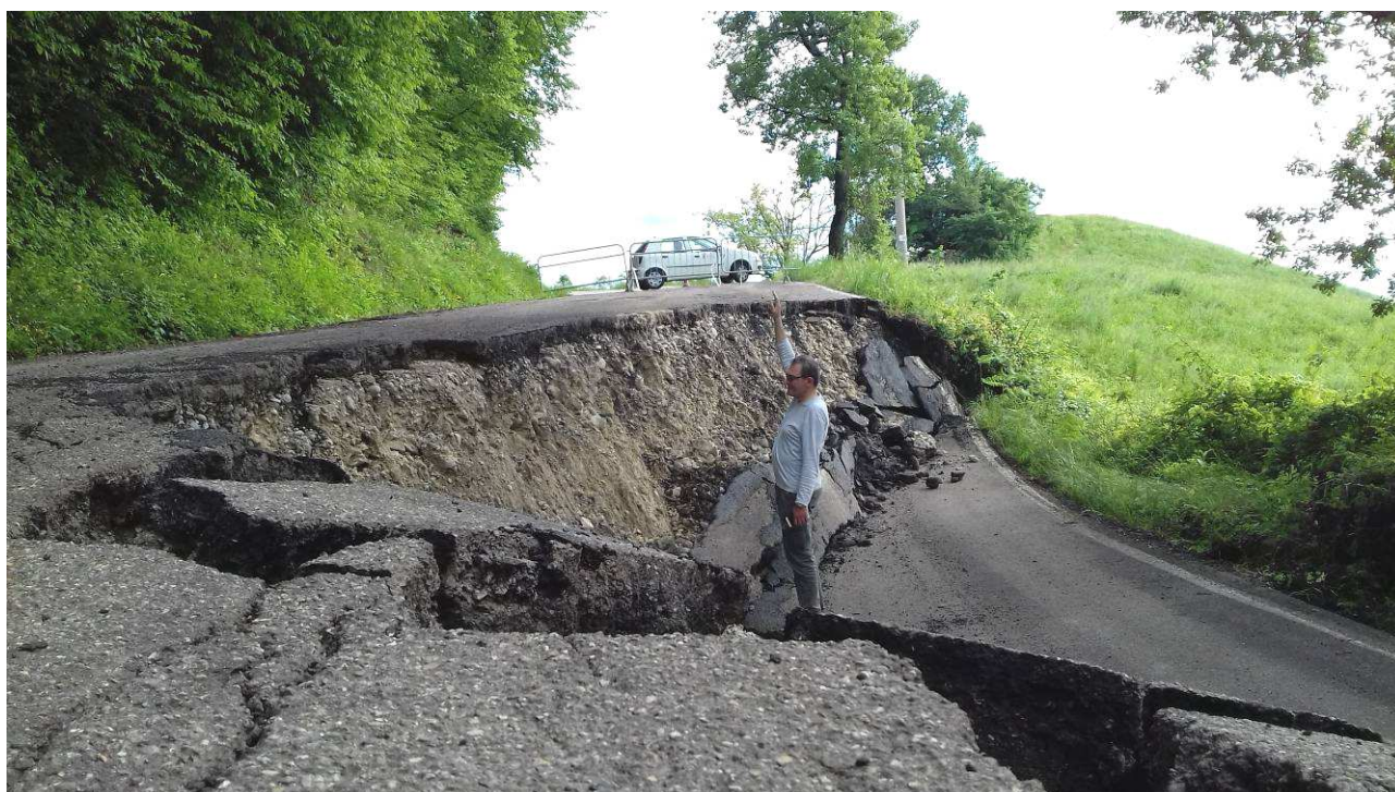
Foto 4 – Vista da nord del tratto interessato dal cedimento della sede stradale, con particolare dell'abbassamento dal piano viabile in corrispondenza della nicchia di distacco (30/05/2019).
