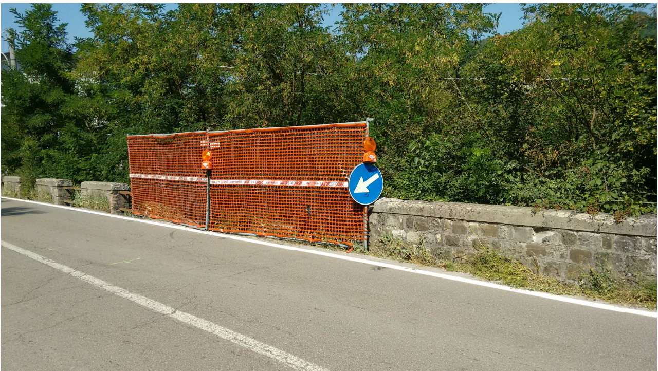
PONTE SUL RIO CURRADA AL KM 32+450 DELLA SP513R SITUAZIONE ATTUALE DOPO L'INCIDENTE SUL LATO DI VALLE:
