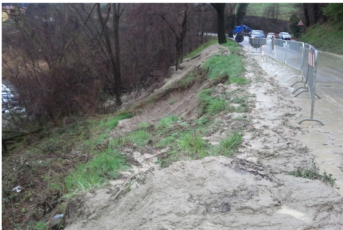
Foto 2 – Particolare della scarpata di valle lungo il tratto di strada interessato dal dissesto.
