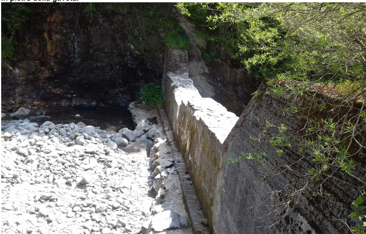
Foto 3 – Vista di valle della briglia danneggiata, si nota il sifonamento in sponda destra.
