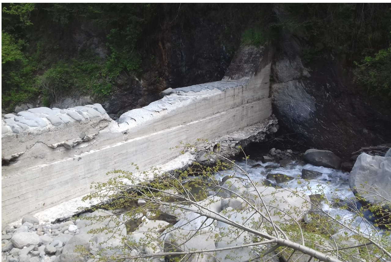
Foto 2 – Particolare della briglia dal quale si nota il sifonamento e il danneggiamento della copertina in pietra della gaveta.
