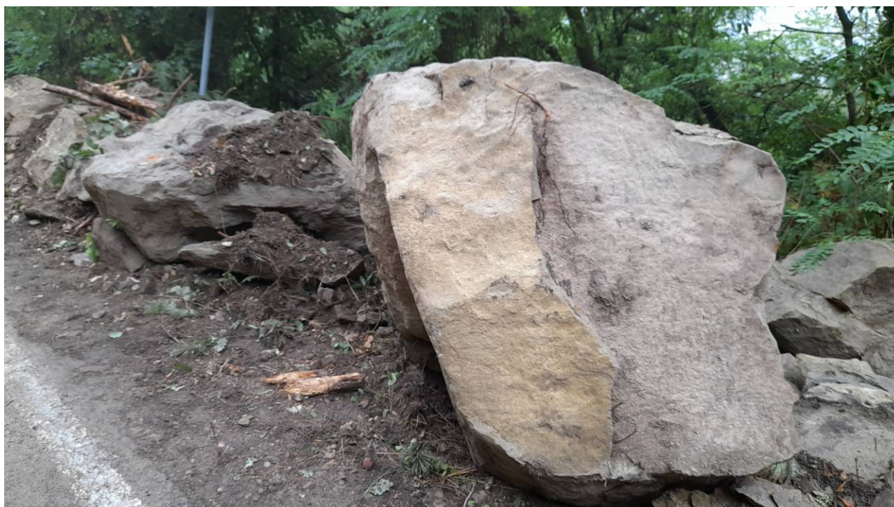
Foto 3 – Particolare dei massi crollati.
