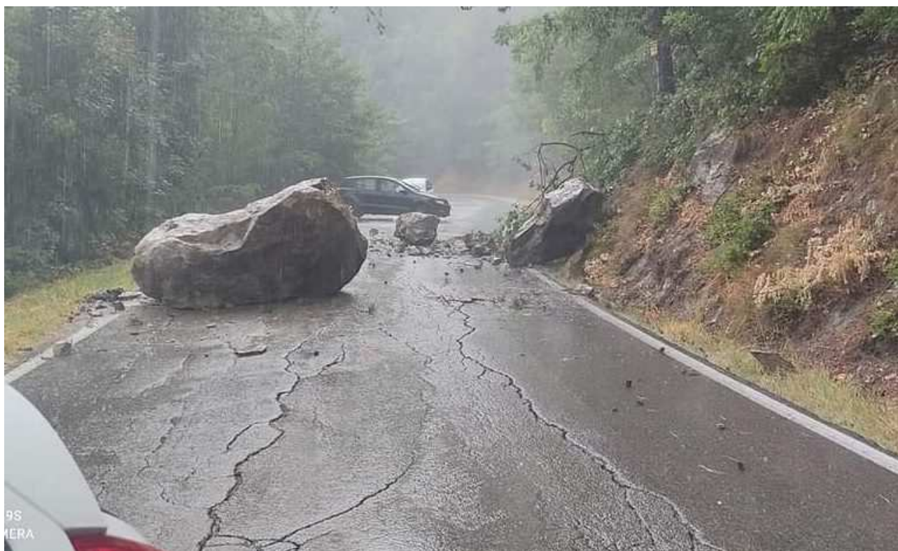
Foto 2 – Vista del materiale caduto sulla carreggiata.
