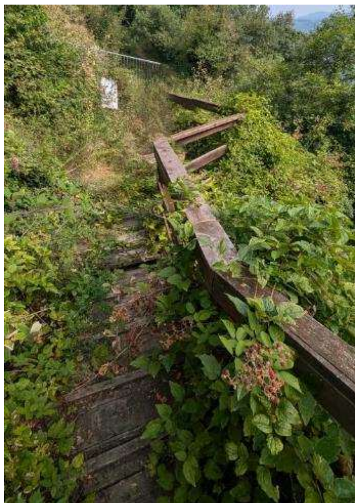
Foto 8 – Ponticello in legno da ripristinare mediante sostituzione degli elementi lignei deteriorati
