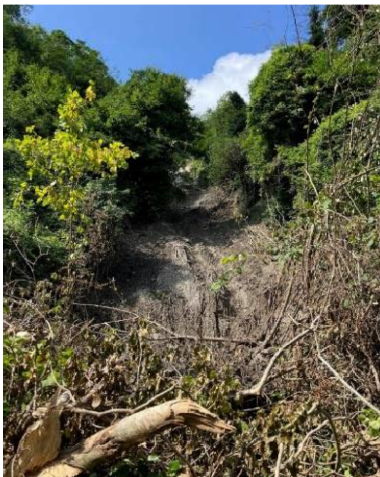
Foto 2 – vista della frana dalla strada
