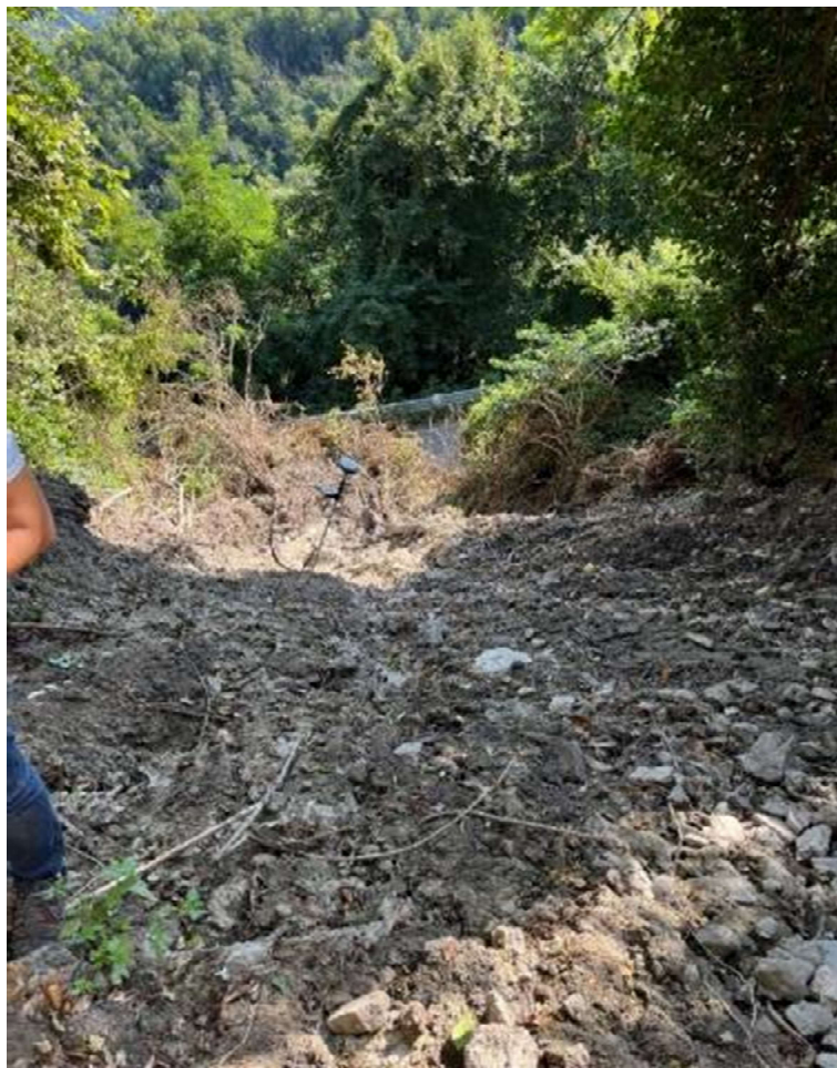
Foto 3 – vista della parte valliva del corpo frana
