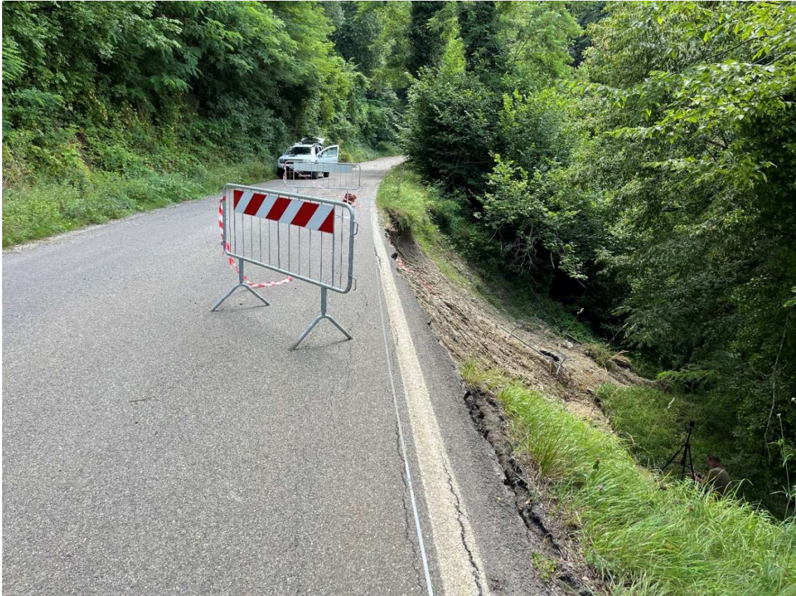
Foto 1 – vista frana da monte
