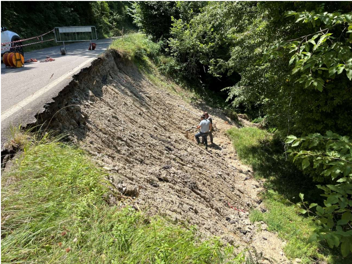
Foto 2 – vista frana da monte
