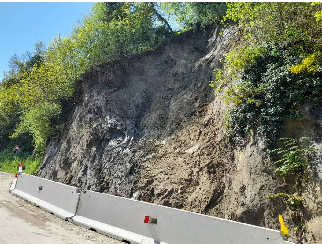
Foto 2 - vista del versante oggetto di dissesto lungo la SP 76 al km 1+680 e del materiale terroso e roccioso distaccato
