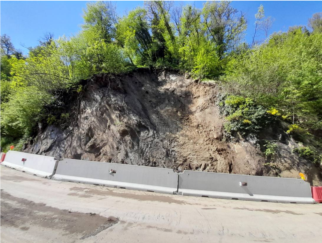
Foto 1 – vista del versante oggetto di dissesto lungo la SP 76 al km 1+680 con barriera in new jersey
