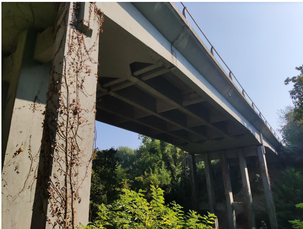
Percolazione in corrispondenza dei giunti e delle selle gerber
