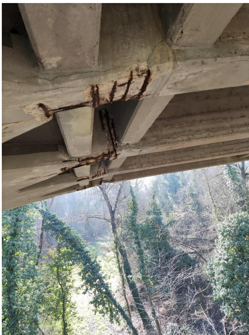
Corrosione diffusa in corrispondenza delle Selle Gerber
