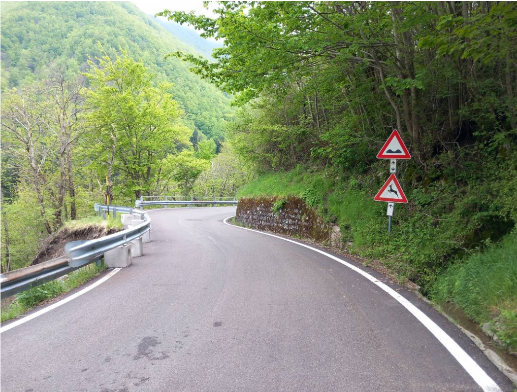
Foto 2 - vista della SP 96 nel tratto interessato dal dissesto della scarpata di valle, con installata la barriera temporanea
