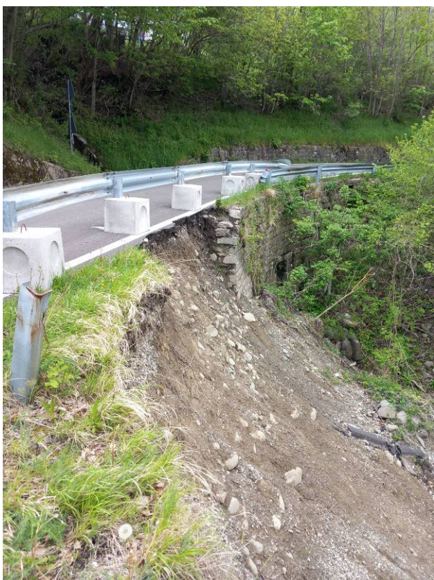
Foto 5 - vista del dissesto del versante di valle, a lato del muro esistente, con interessamento della carreggiata stradale
