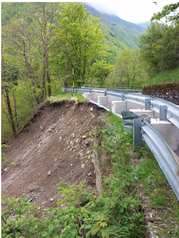
Foto 4 - vista del dissesto del versante di valle con interessamento della carreggiata stradale
