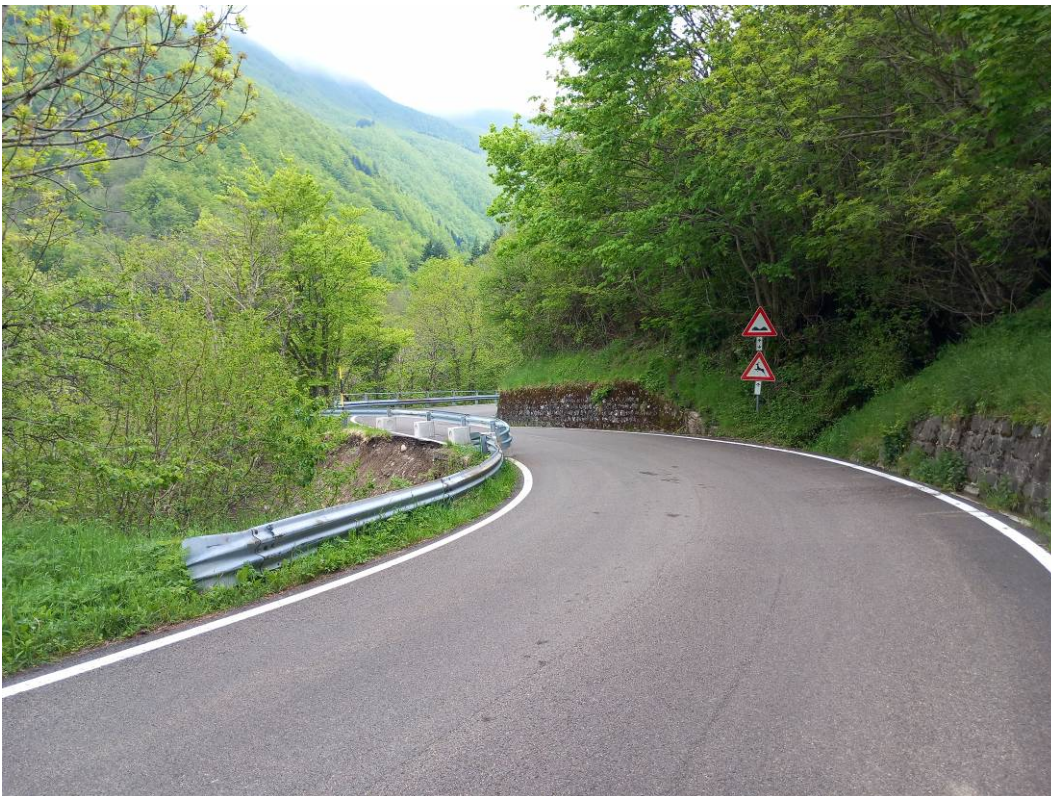
Foto 1 – vista della SP 96 nel tratto interessato dal dissesto della scarpata di valle
