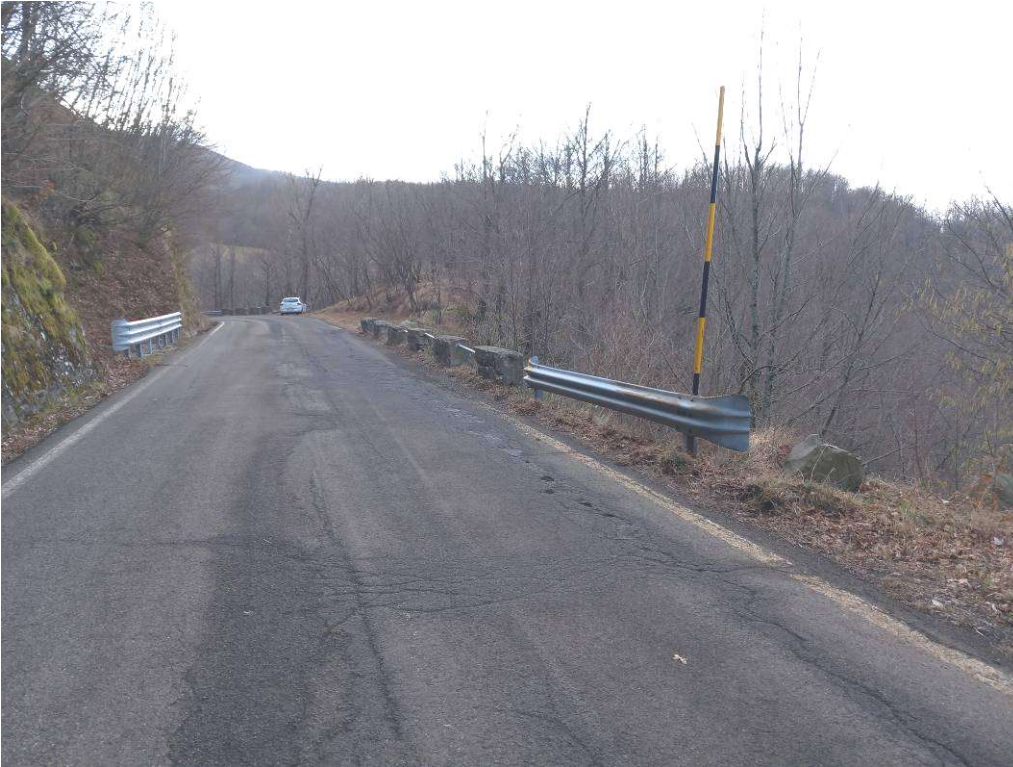
Foto 3 - vista del tratto stradale e dei sistemi di ritenuta in corrispondenza del muro B, Intervento 02; si nota il degrado del piano viabile con presenza di fessurazioni e sconnessioni
