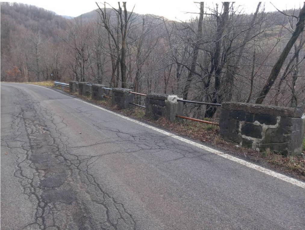
Foto 6 - vista del tratto stradale e dei sistemi di ritenuta in corrispondenza del muro D, Intervento 03; si nota il degrado del piano viabile con presenza di fessurazioni longitudinali e ramificate e presenza di buche e rappezzi
