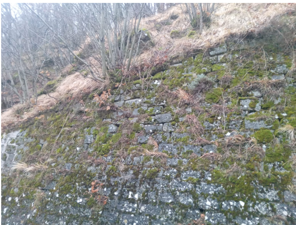
Foto 10 - vista del dissesto del muro di monte (muro F), Intervento 04
