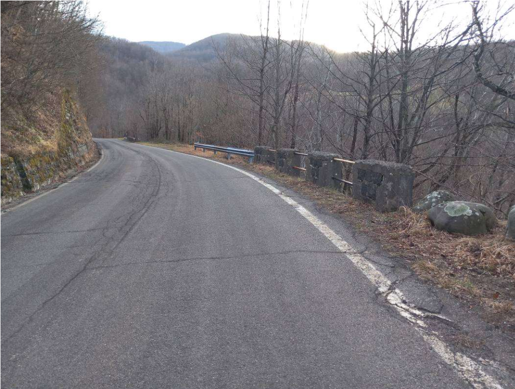
Foto 5 - vista del tratto stradale e dei sistemi di ritenuta in corrispondenza del muro C, Intervento 02
