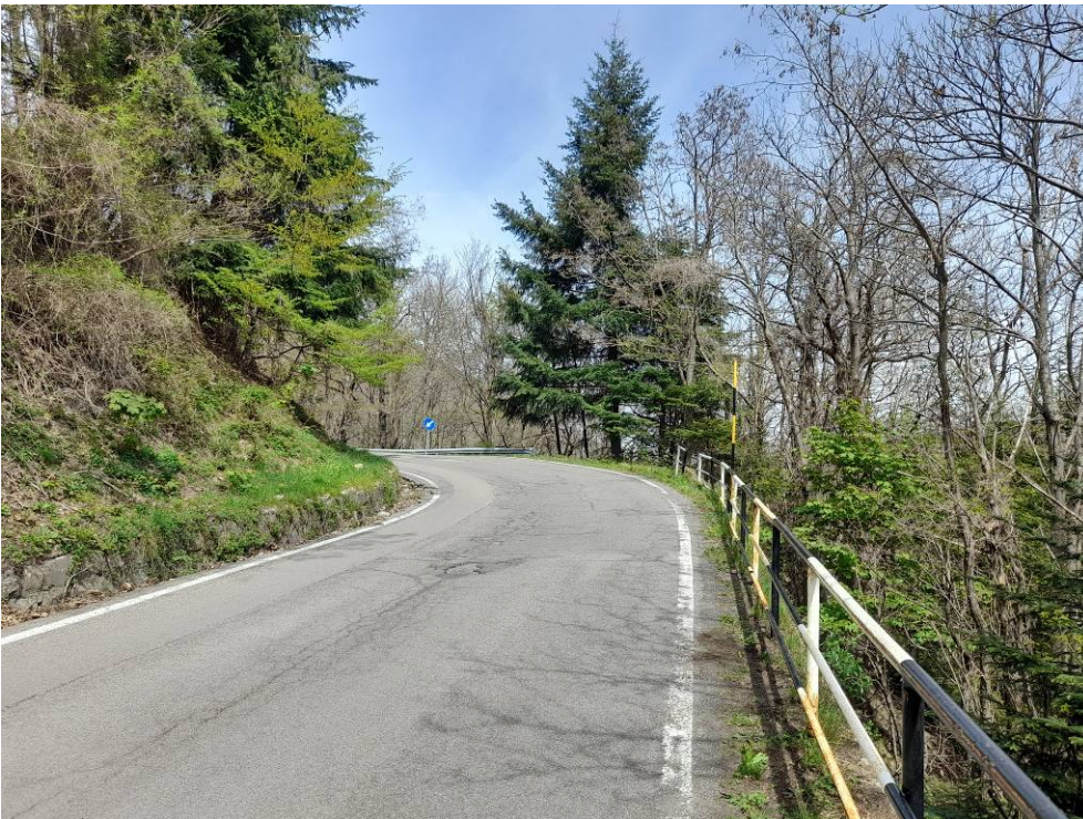
Foto 8 – vista della pavimentazione stradale danneggiata e del parapetto in tubolari metallici non regolamentare
