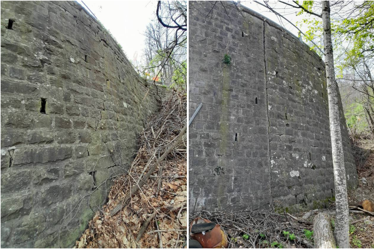
Foto 1 – vista del muro sottoscarpa con fessurazioni, all’intersezione con SP 18
