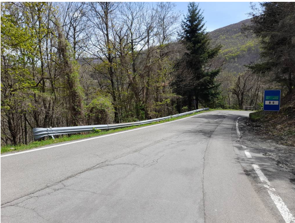
Foto 6 – vista della pavimentazione stradale danneggiata e della barriera bordo laterale deformata e con cedimento della banchina
