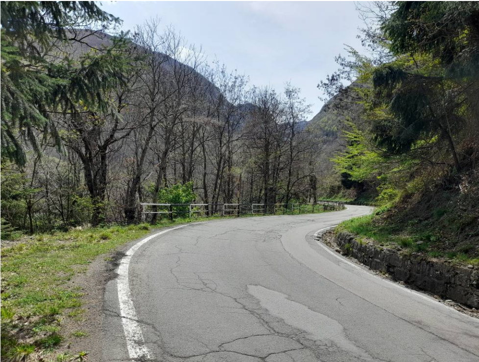
Foto 7 – vista della pavimentazione stradale danneggiata e del parapetto in tubolari metallici non regolamentare
