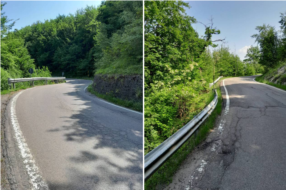
Foto 13 – vista della pavimentazione stradale deteriorata e della barriera non regolamentare
