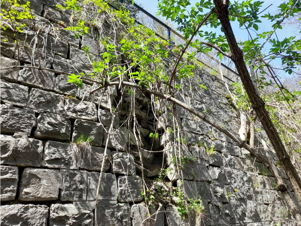
Foto 3 – vista del muro sottoscarpa con crolli e perdita di conci ed erosione dei giunti
