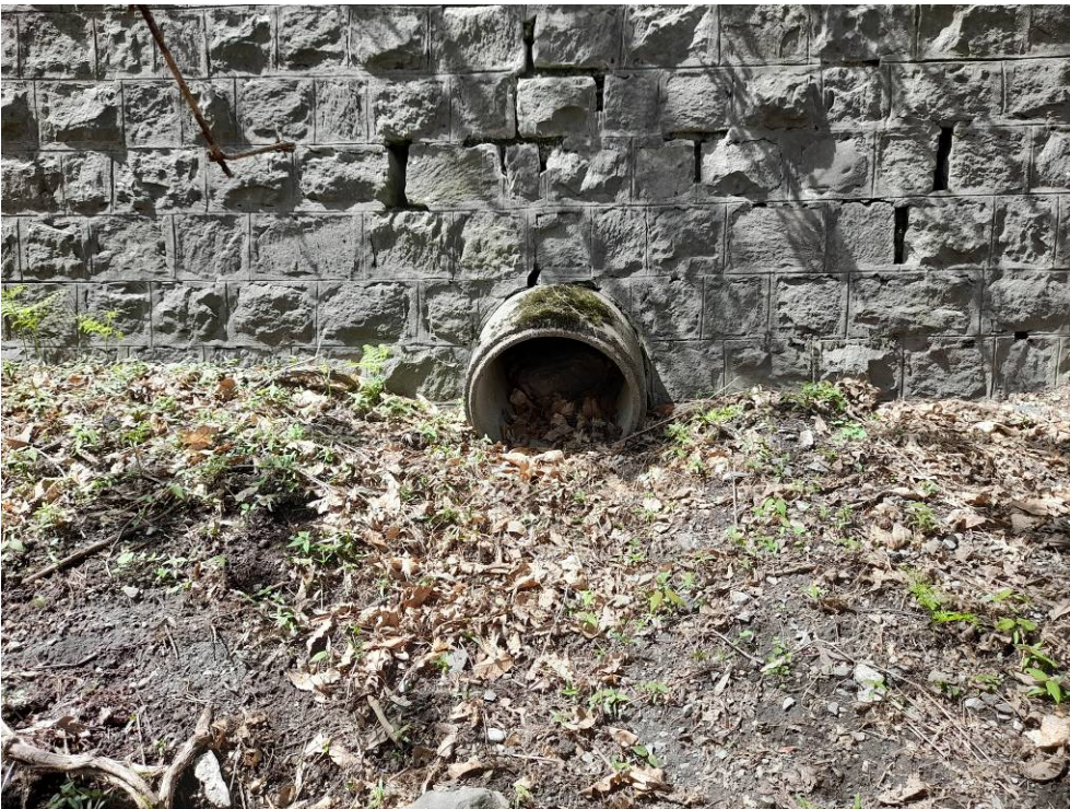
Foto 4 – vista del muro sottoscarpa con erosione dei giunti e dell'attraversamento idraulico parzialmente ostruito
