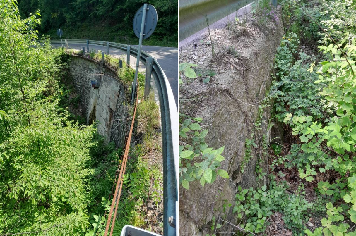
Foto 9 – vista del muro sottoscarpa lato Sologno, con disgregazione del calcestruzzo del cordolo, perdita del copriferro ed ossidazione dell’armatura
