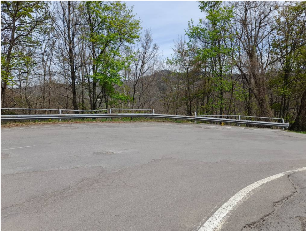
Foto 5 – vista della pavimentazione stradale danneggiata e della barriera bordo ponte deformata
