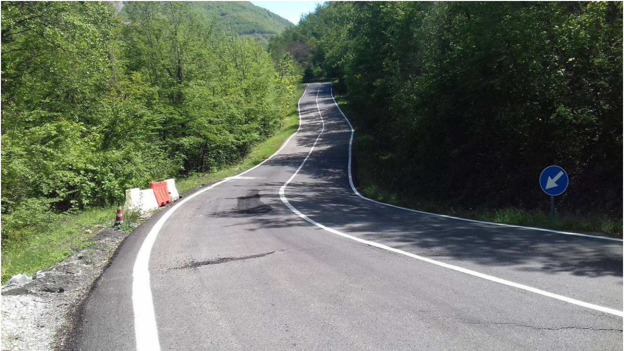
Foto 2 – Vista del tratto di strada verso il km 18+870, dove si nota la deformazione planimetrica ed un abbassamento lungo il ciglio di valle.
