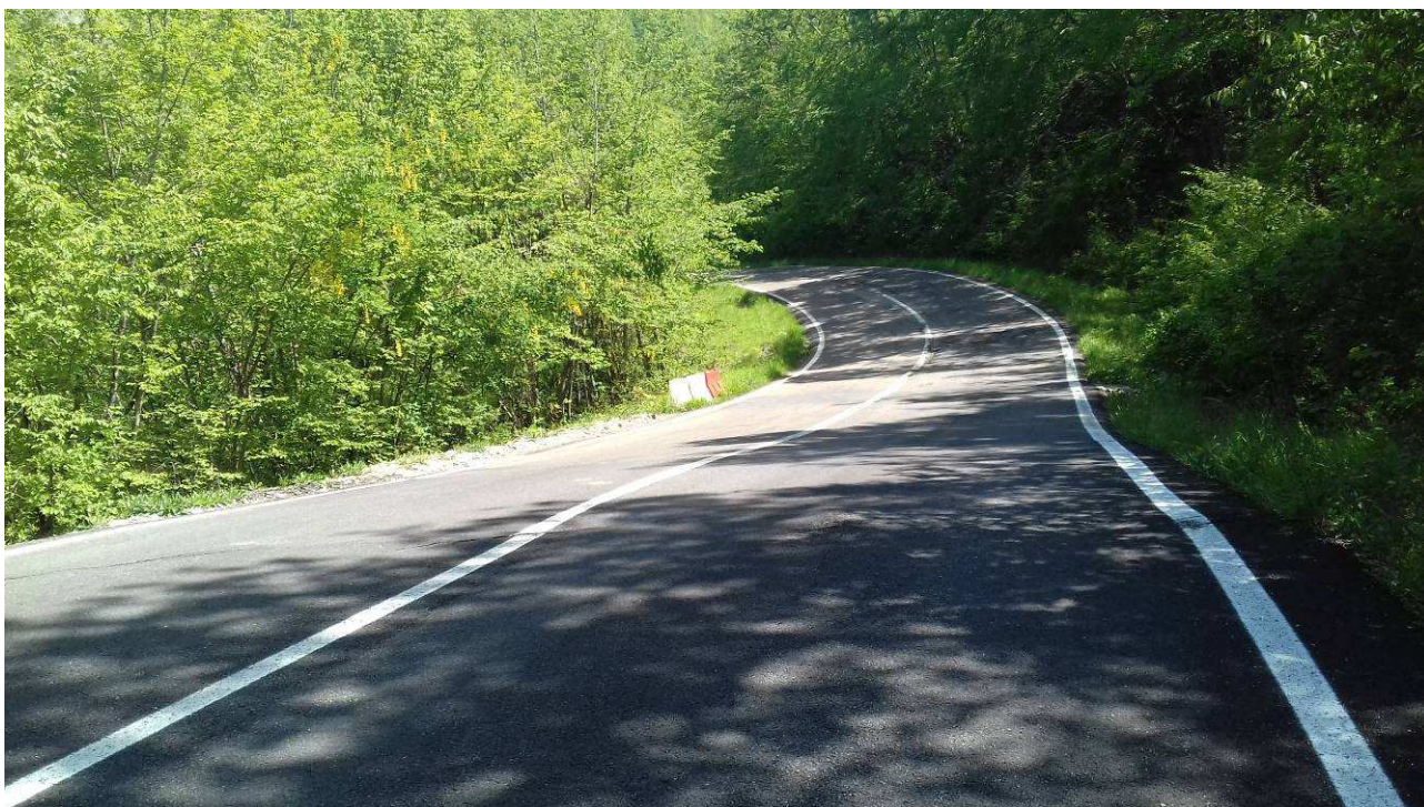
Foto 1 – Particolare del piano viabile al km 18+600, dove si nota la deformazione planimetrica del piano viabile sul lato di valle.
