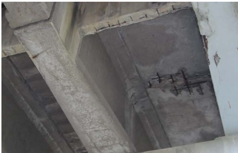
Figura 24 – degrado dell'intradosso dell'impalcato, probabilmente dovuto ad infiltrazioni d'acqua
