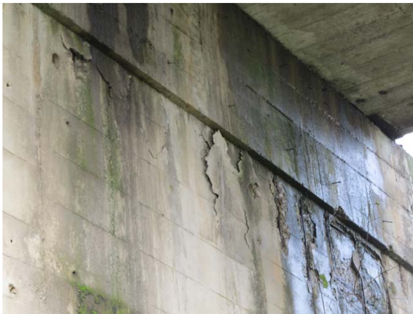
Figura 14 – esempio di degrado sui muri in c.a. delle spalle
