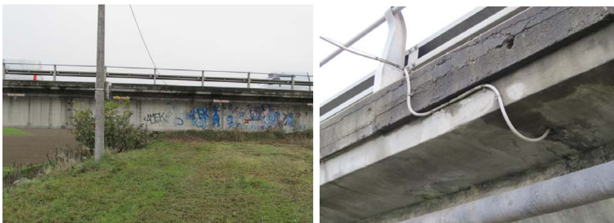
Figura 28 – palo con linea aerea BT (foto sx), cavo linea BT entrante nel cordolo lato di monte (foto dx)
