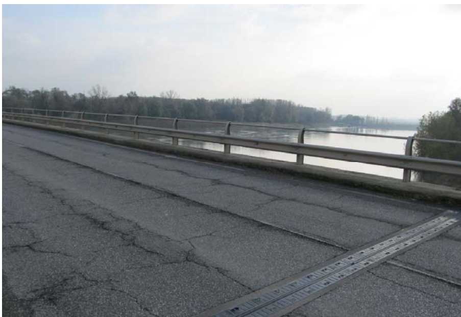
Figura 23 – fessurazioni a blocchi e avvallamenti tra la posione delle travi dell'impalcato.
