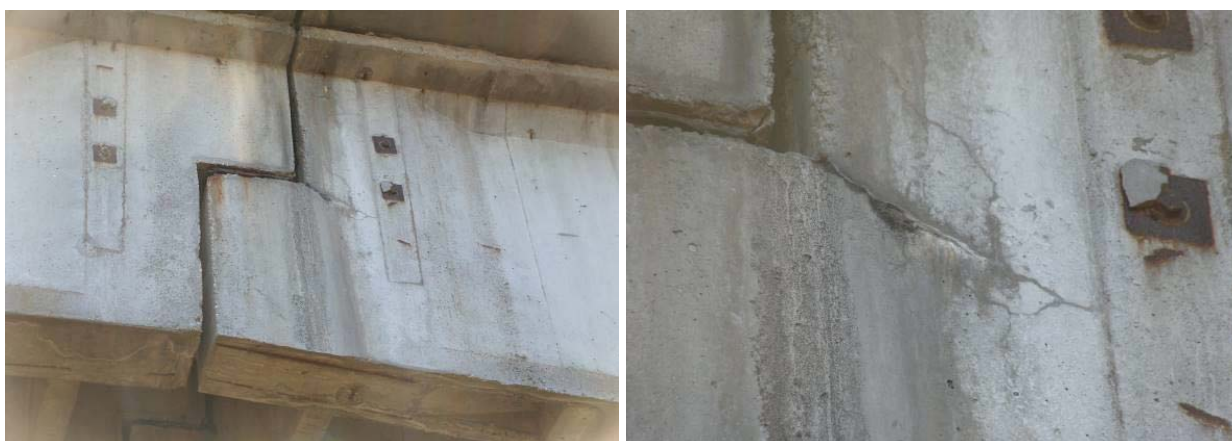
Figura 10 – Fessure diagonali su selle Gerber, una sulla campata VII da monte sulla facciata esterna della trave di bordo sinistro, su tutte le selle della campata IX da monte ed una sulla sella di monte della trave di bordo sinistra sulla campata VIII da monte
