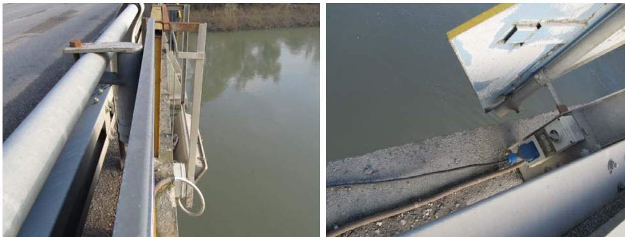
Figura 29 – impianti ed apparecchiature elettriche presenti sul ponte in prossimità del centro dell'alveo di magra
