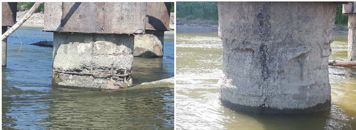
Figura 20 – nidi di ghiaia e mancanza di corripferro sulle pile in alveo
