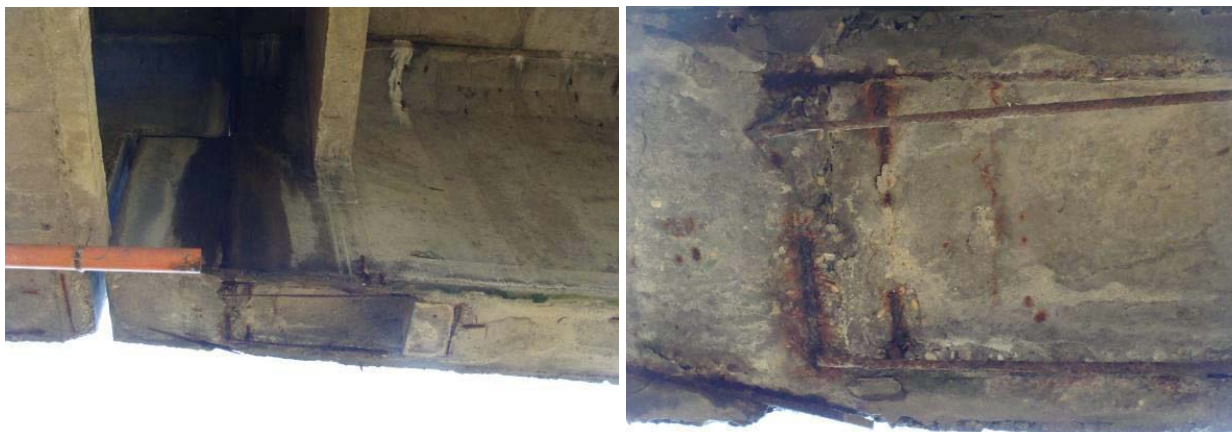
Figura 9 – Degrado delle selle Gerber con dilavamento, distacco copriferro con armatura e staffe corrose con riduzione di sezione resistente
