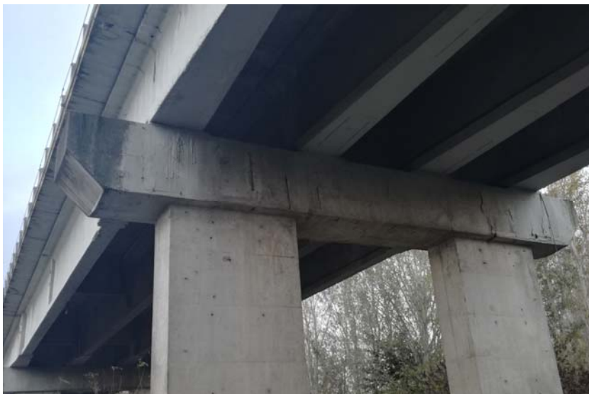
Figura 18 – dilavamento delle testate dei pulvini e degrado con distacco e rigonfiamento del copriferro
