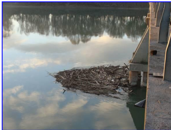
Detriti alla base delle pile
