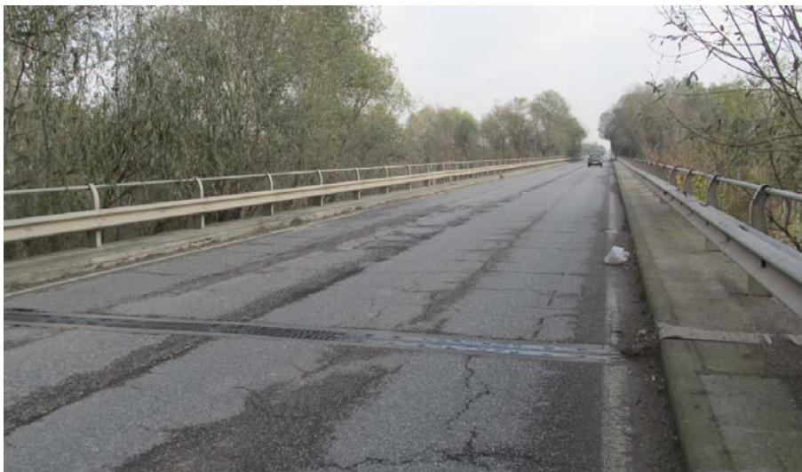
Figura 22 – fessurazioni a blocchi secondo gli assi della struttura dell'impalcato
