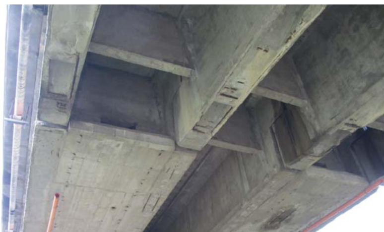
Figura 16 – degrado sulle travi precomprese con distacco del copriferro e ossidazione dell'armatura
