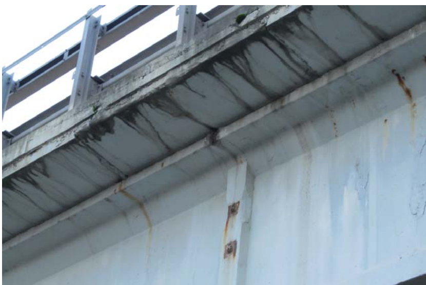
Figura 19 – dilavamento lungo lo sbalzo dell'impalcato
