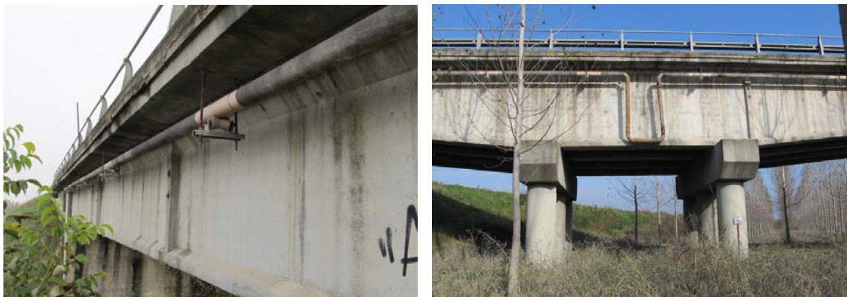
Figura 27 – condotta gas metano lato di monte (foto sx), giunto di dilatazione della condotta (foto dx)
