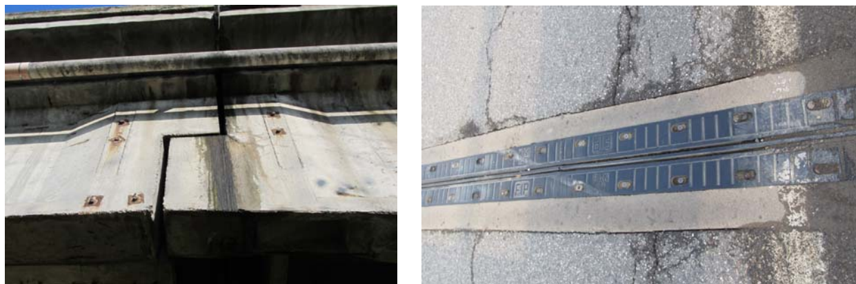
Figura 12 – dilavamento attraverso il giunto (foto sx), giunto esistente (foto dx)
