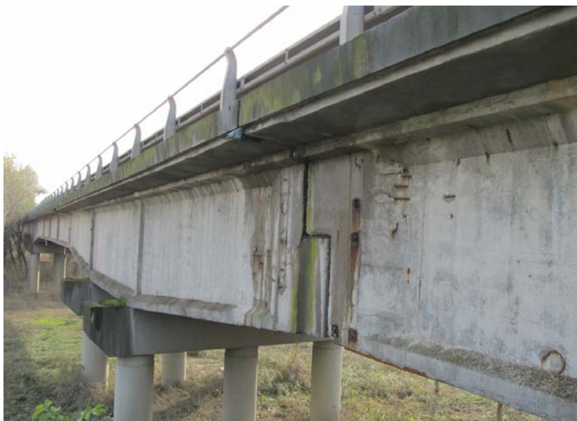
Figura 15 – dilavamento in corrispondenza della sella , distacco del copriferro
