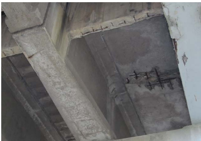
Figura 17 – degrado dell'intradosso dell'impalcato con distacco del copriferro e ossidazione dell'armatura
