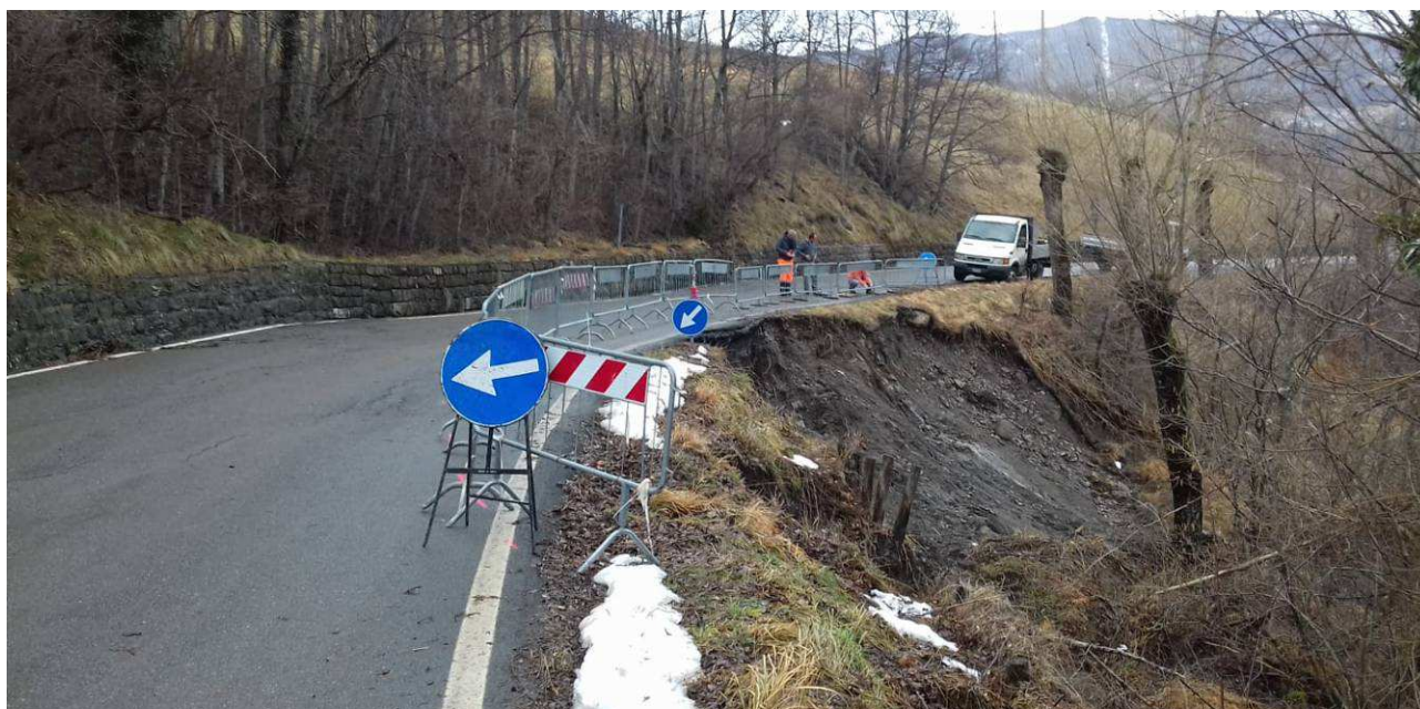
Foto 1 – Vista da ovest del dissesto che ha interessato la scarpata di valle, durante le fasi di istituzione del senso unico alternato a vista con limitazione della velocità (02/02/2019).
