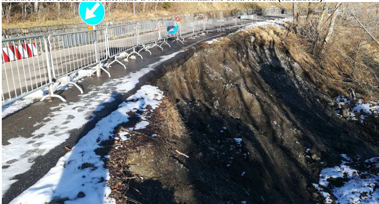
Foto 2 – Particolare dell'evoluzione del dissesto lungo la scarpata di valle, con cedimento completo della banchina stradale (05/02/2019).
